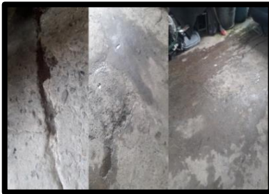
Figura 75 Piso con grietas y mojado Taller Servicios González Fuente: con base a la información obtenida
