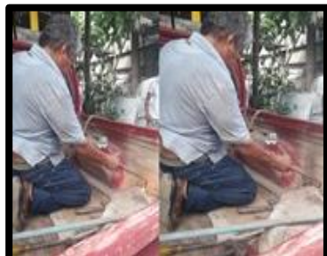
Figura 141 Soldadura autógena sin EPP Taller Manolo Fuente: con base a la información obtenida
