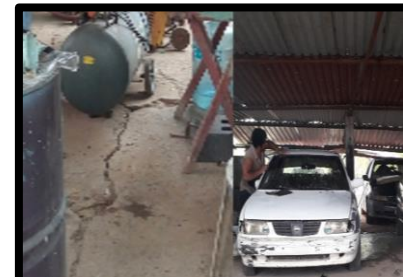
Figura 82 Piso con grietas Taller Mil Años Fuente: con base a la información obtenida
