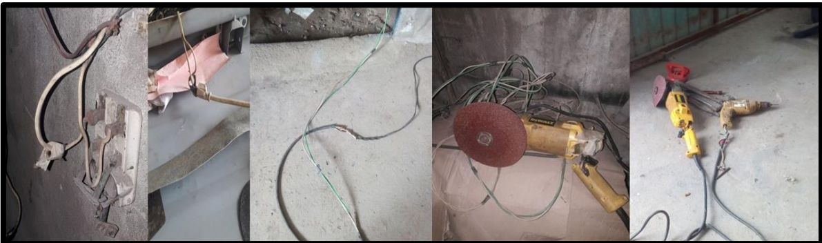
Figura 36 Cableado en mal estado
