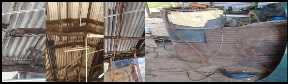
Figura 31 Cableado en mal estado
