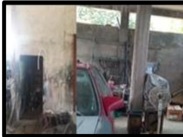
Figura 106 Falta de señalización de seguridad Taller Trino Fuente: con base a la información obtenida
