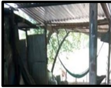
Figura 98 Falta de extintor Taller Mil Años Fuente: con base a la información obtenida
