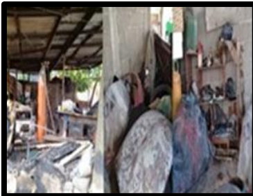
Figura 70 Obstrucción de las vías de circulación y limpieza Taller Don Goyo Fuente: con base a la información obtenida
