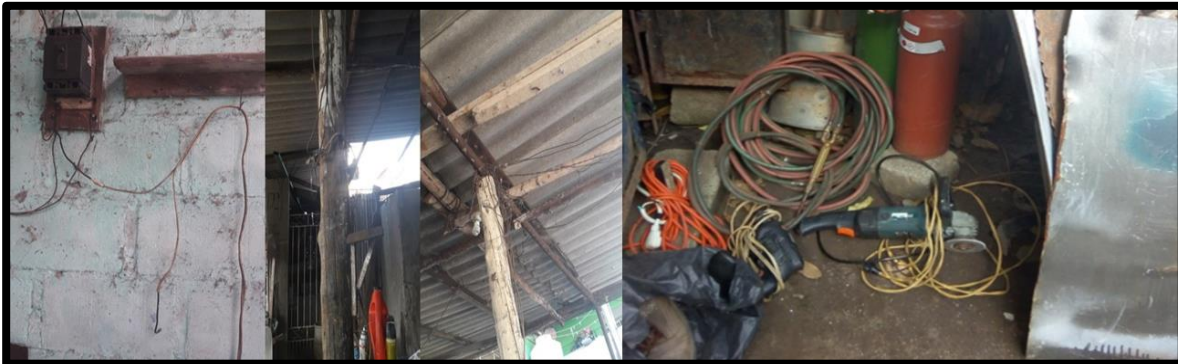
Figura 41 Cableado en mal estado
