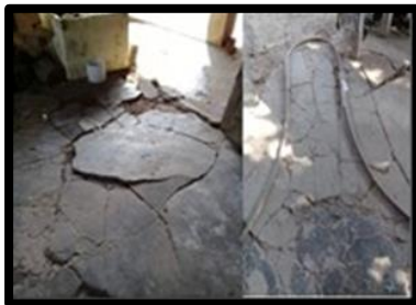
Figura 78 Piso con grietas Taller Don Goyo Fuente: con base a la información obtenida
