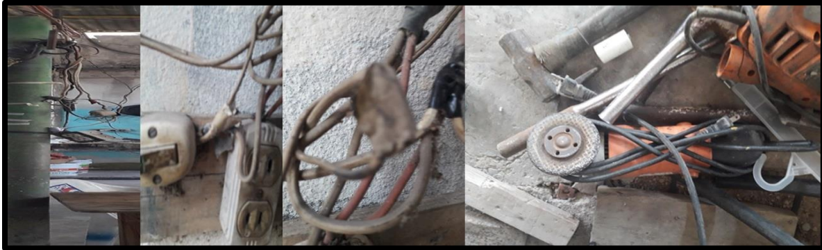
Figura 51 Cableado en mal estado
