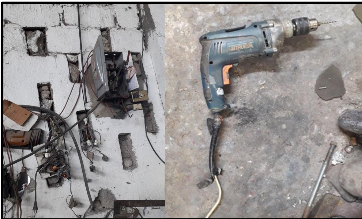
Figura 16 Cableado en mal estado
