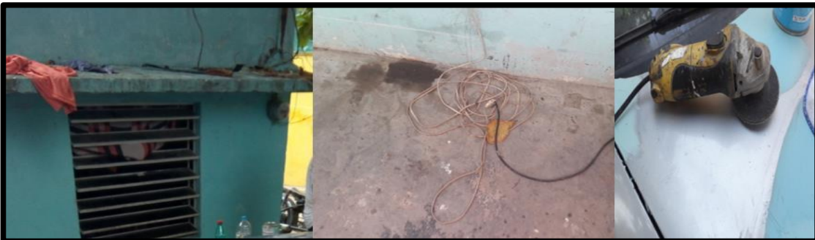
Figura 26 Cableado en mal estado
