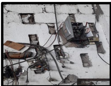
Figura 59 Instalación eléctrica Taller Servicios González Fuente: con base a la información obtenida
