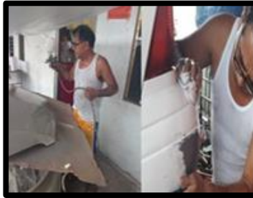
Figura 129 Aplicación de pintura y lijado sin EPP Taller Almendro Fuente: con base a la información obtenida
