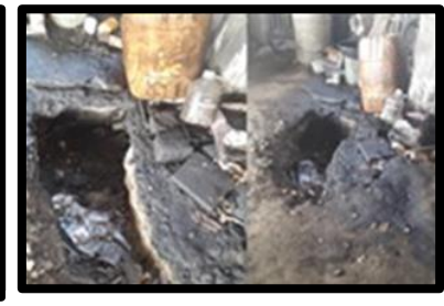
Figura 80 Piso con agujero Taller Manolo Fuente: con base a la información obtenida
