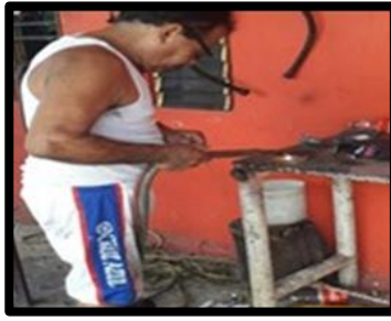
Figura 137 Soldadura autógena sin EPP Taller El Almendro Fuente: con base a la información obtenida
