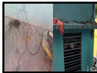
Figura 61 Instalación eléctrica Taller El Mosco Fuente: con base a la información obtenida
