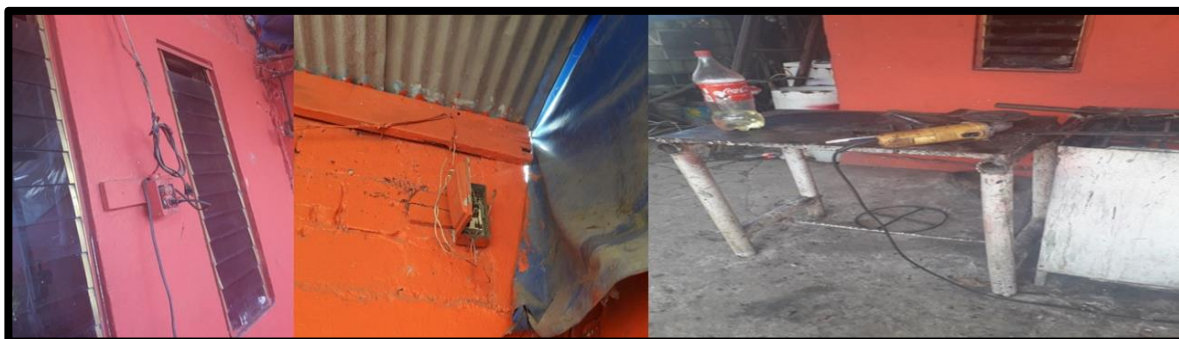
Figura 21 Cableado en mal estado
