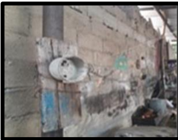
Figura 94 Falta de extintor Taller El Flaco Fuente: con base a la información obtenida
