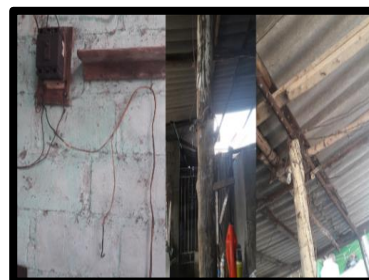
Figura 64 Instalación eléctrica Taller Manolo Fuente: con base a la información obtenida
