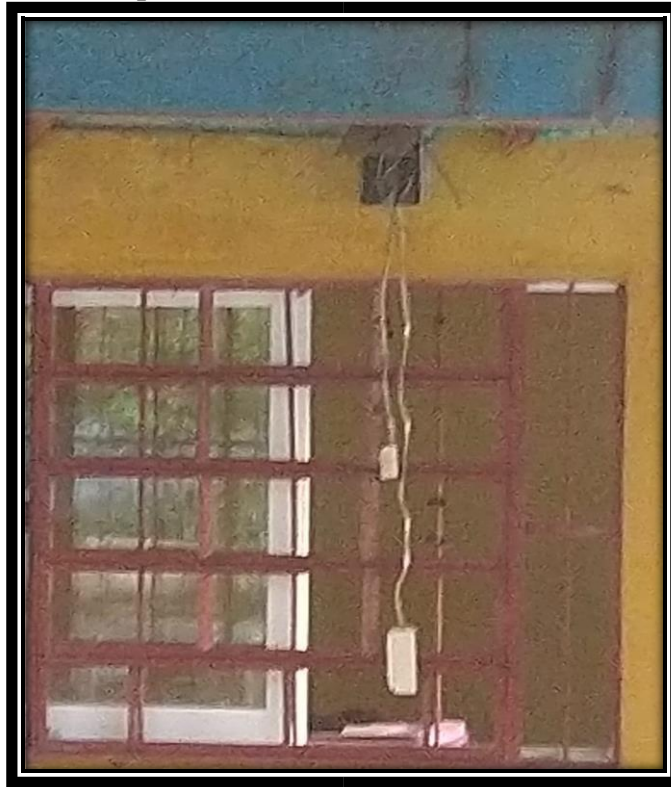
Figura 22: Instalación eléctrica del comedor enfrente de la cocina
