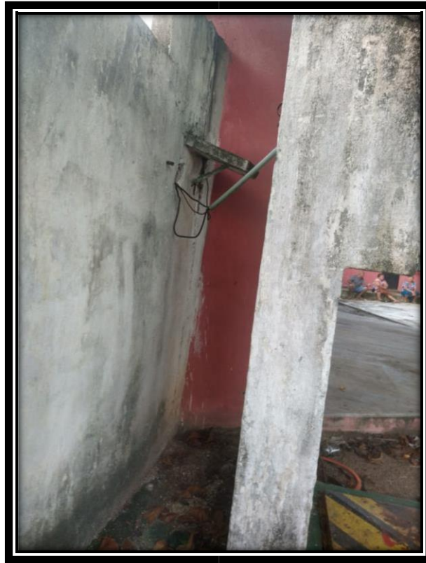
Figura 15: Instalación eléctrica de la primaria
