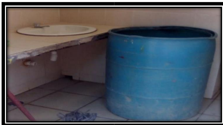
Figura 19: Baño con loseta desprendidas y agua en el piso
