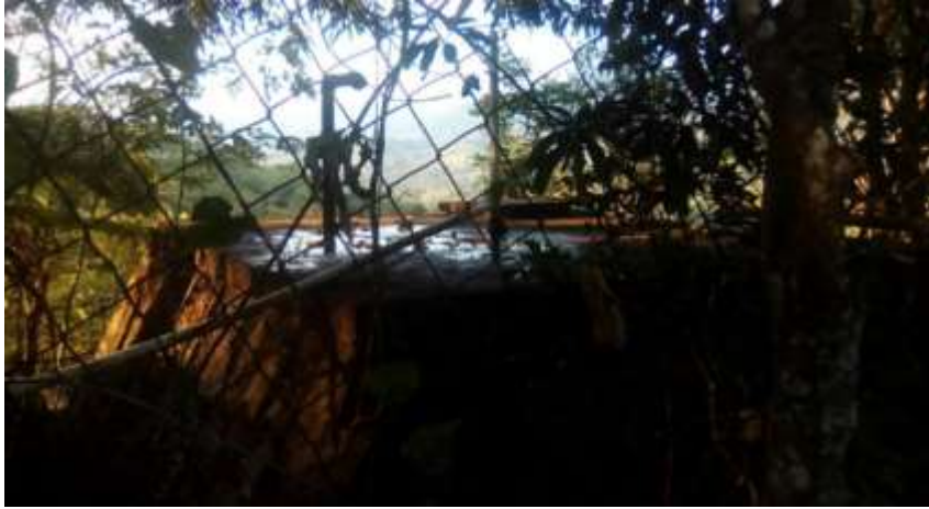
Fotografía. 5. Tanques de agua
