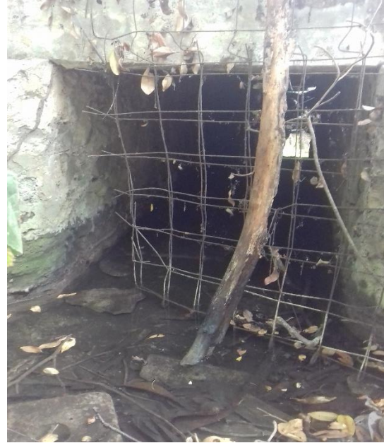
Foto 5. Sendero parte baja de la Reserva. Bloqueo insuficiente para la protección de intrusión. UTM; Long. 489666.1 N, Lat. 1849474.1 W a 632 msnm. Reserva Ecológica El Zapotal, Tuxtla Gutiérrez, Chiapas.
