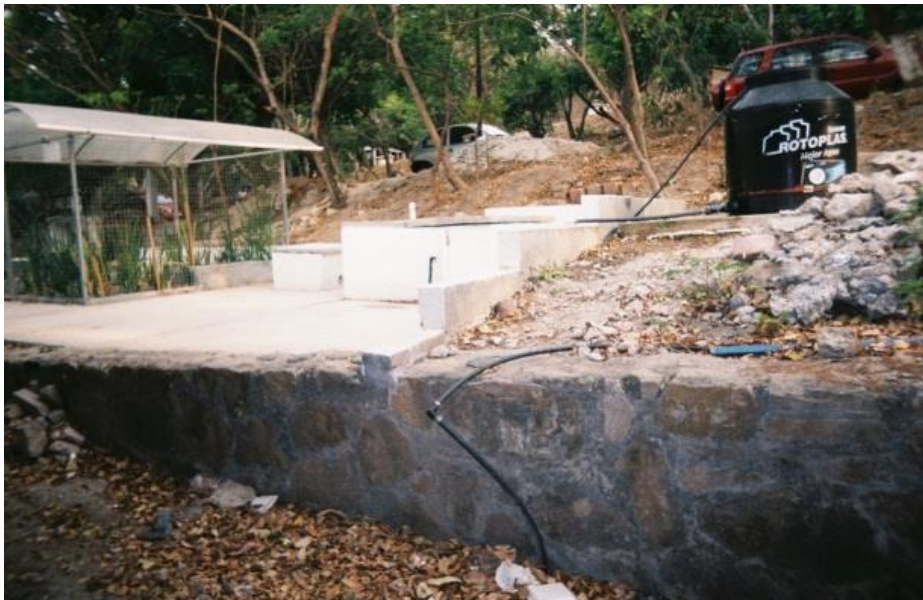
Figura 7. El tanque alimentador al biodigestor del Sistema Integral anaerobio-humedal.
