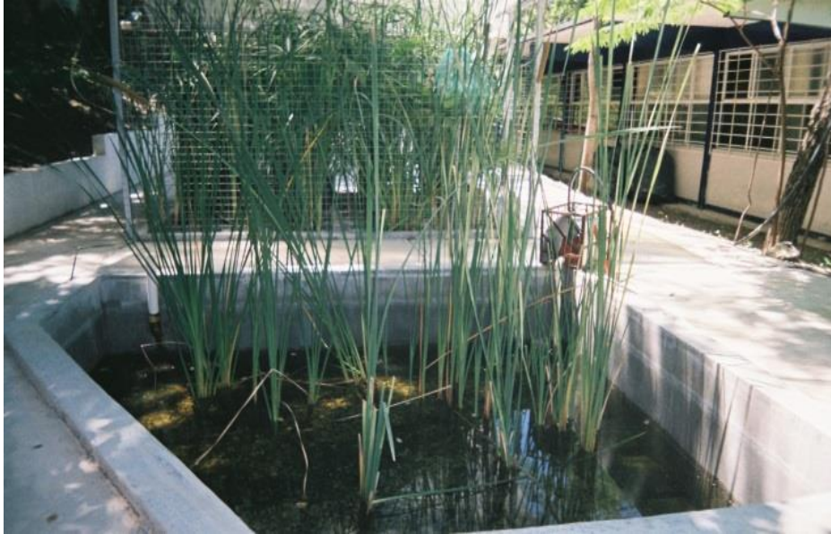
Figura 10. Tanque receptor de aguas tratadas finalmente por el Sistema Integral anaerobio-humedal.
