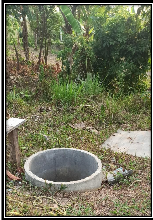
Figura 21: Pozo sin tapa y señalización
