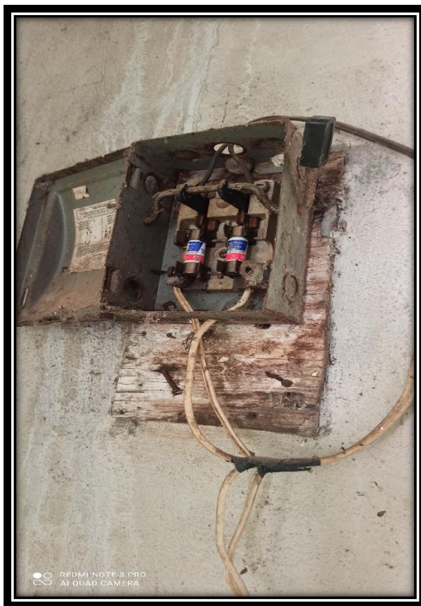
Figura 8: Instalación eléctrica en mal estado
