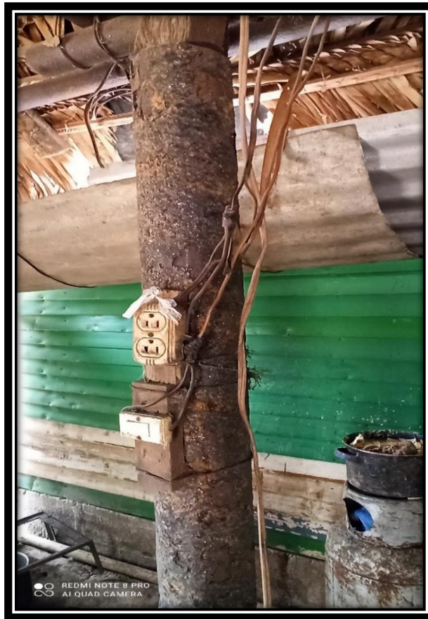
Figura 14: Instalación eléctrica vieja
