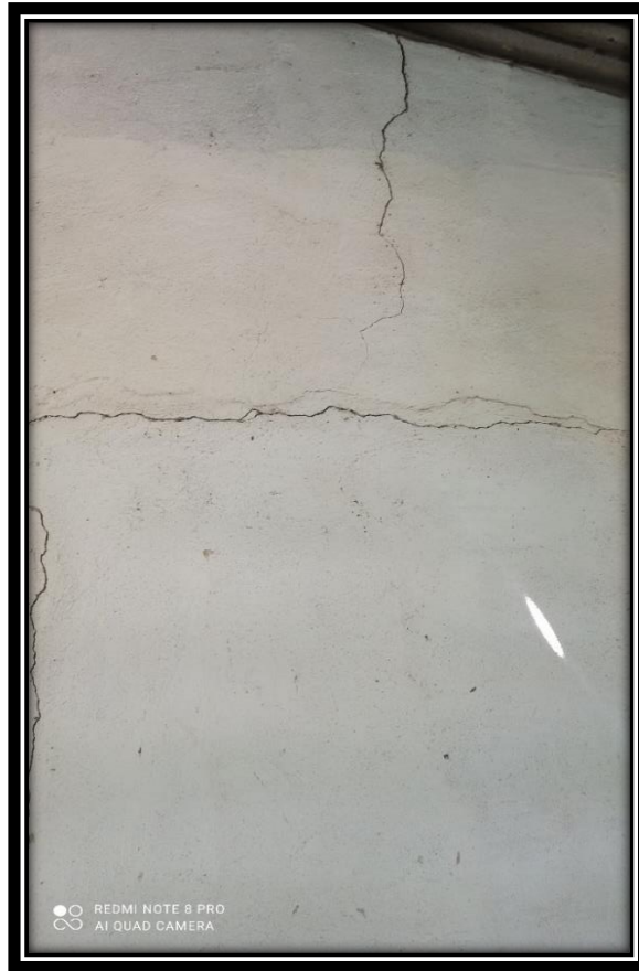
Figura 20: Paredes con grietas
