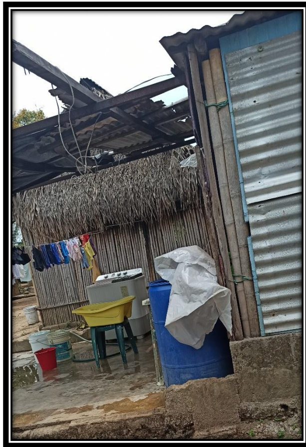
Figura 18: Viviendas en malas condiciones
