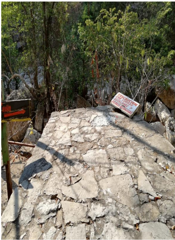
Figura 40. Fotografía. Estado de conservación de las señaléticas.
