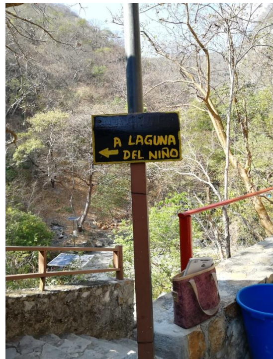
Figura 39. Fotografía. Estado de conservación de las señaléticas.
