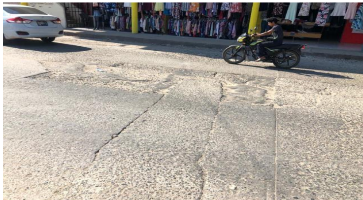
Figura No. 42: Calles en mal estado Fuente: Con base a la información obtenida
