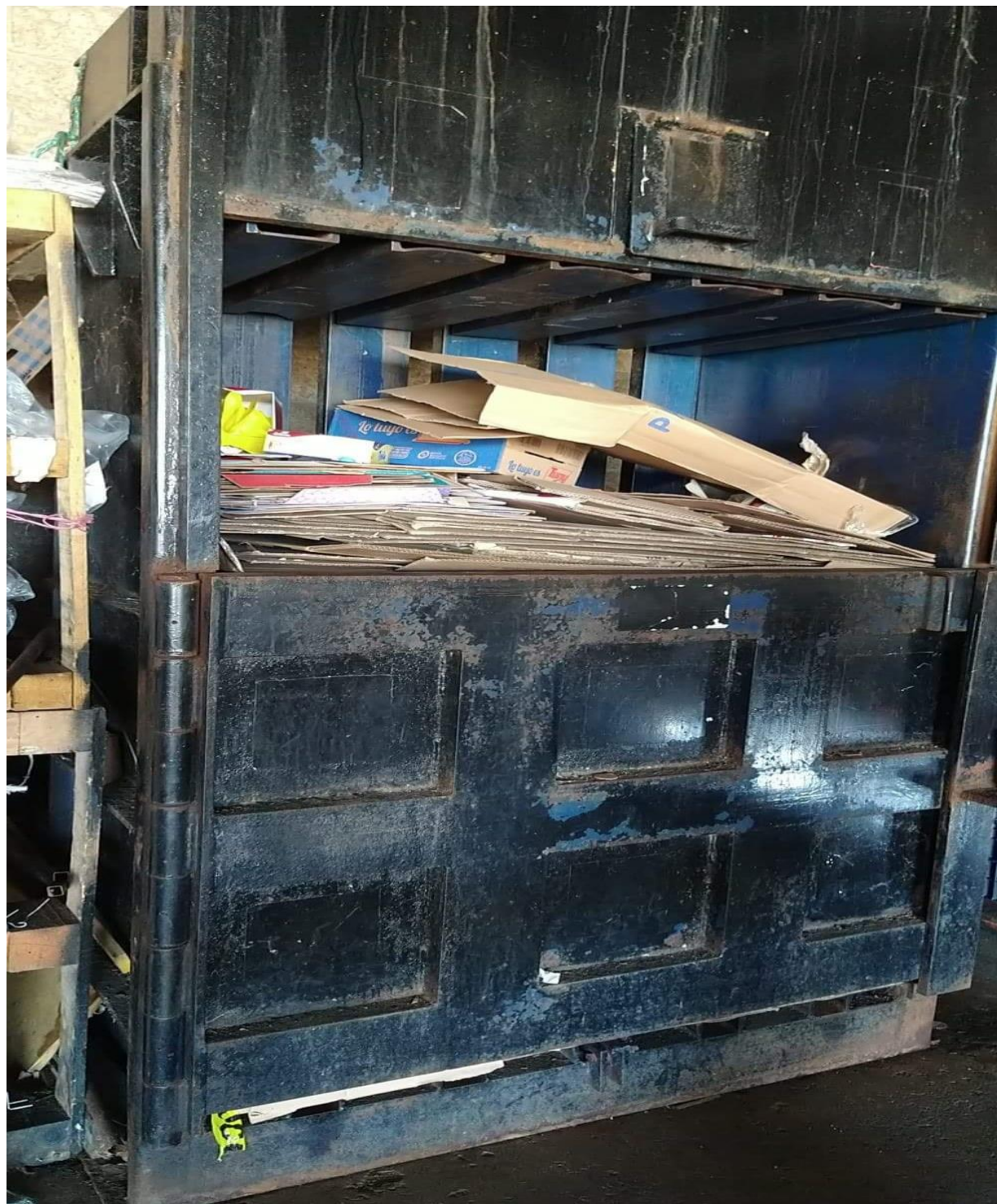
Figura 18.- Prensa Hidráulica compactadora de cartón utilizada dentro de la tienda de autoservicio para reducir el volumen del cartón que se envía al centro de distribución por lo regular en pacas
