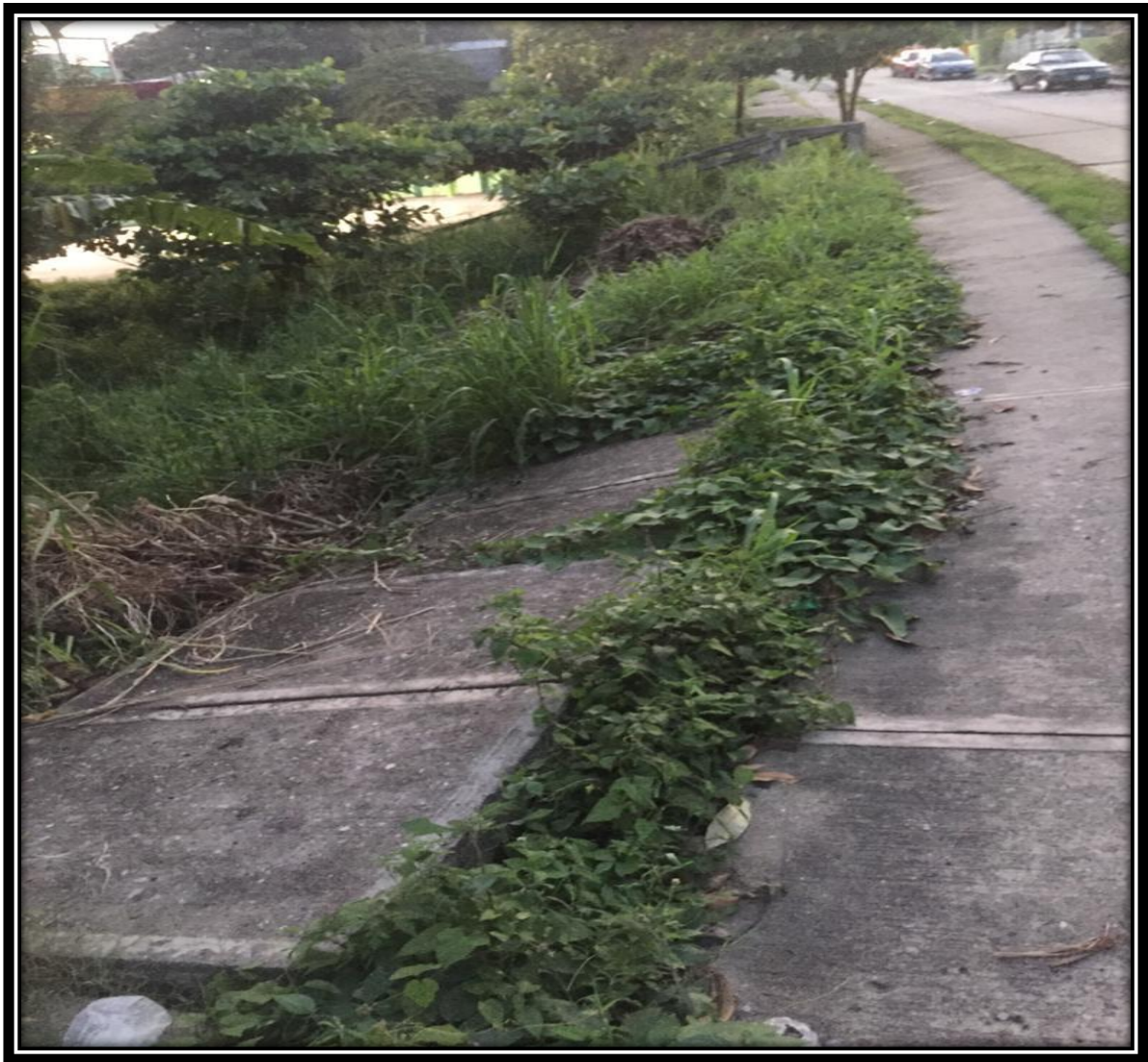
Fig. 13 Banqueta en mal estado (con base a la información obtenida)
