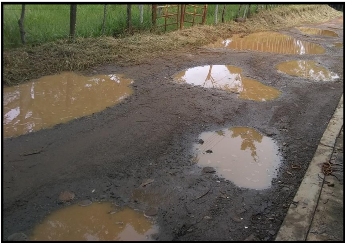
Figura 7. Carretera en mal estado
