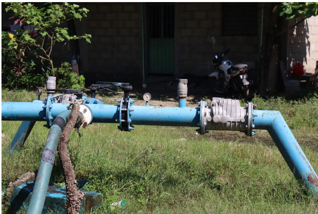
Fotografía 13. Tubería y línea de conducción (pozo Vista Alegre)
