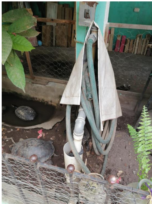
Fotografía 19. Toma de agua potable en una vivienda de Ciudad Hidalgo
