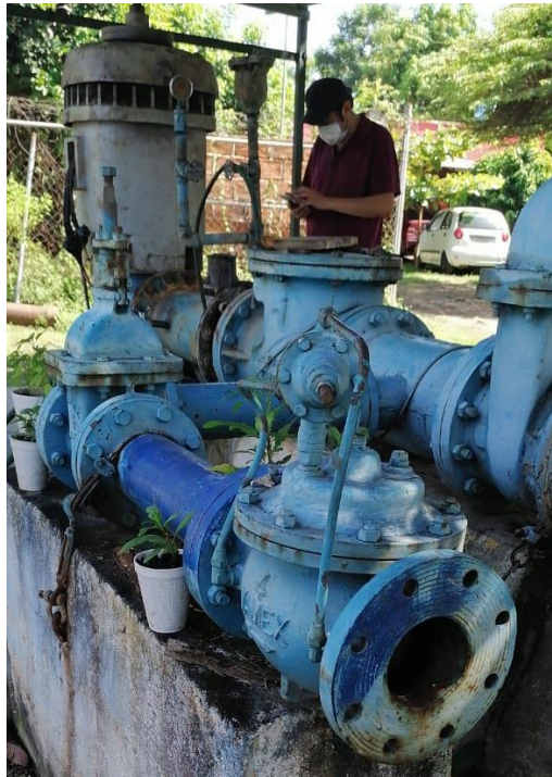
Fotografía 11. Tubería y línea de conducción del agua (pozo Zaragoza)
