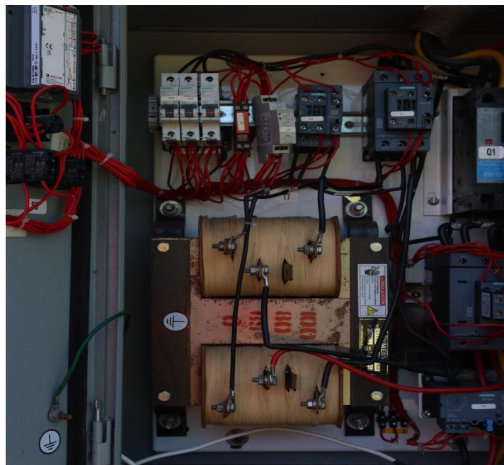
Fotografía 10. Controles de bomba sumergible pozo Manuel Velazco Suarez
