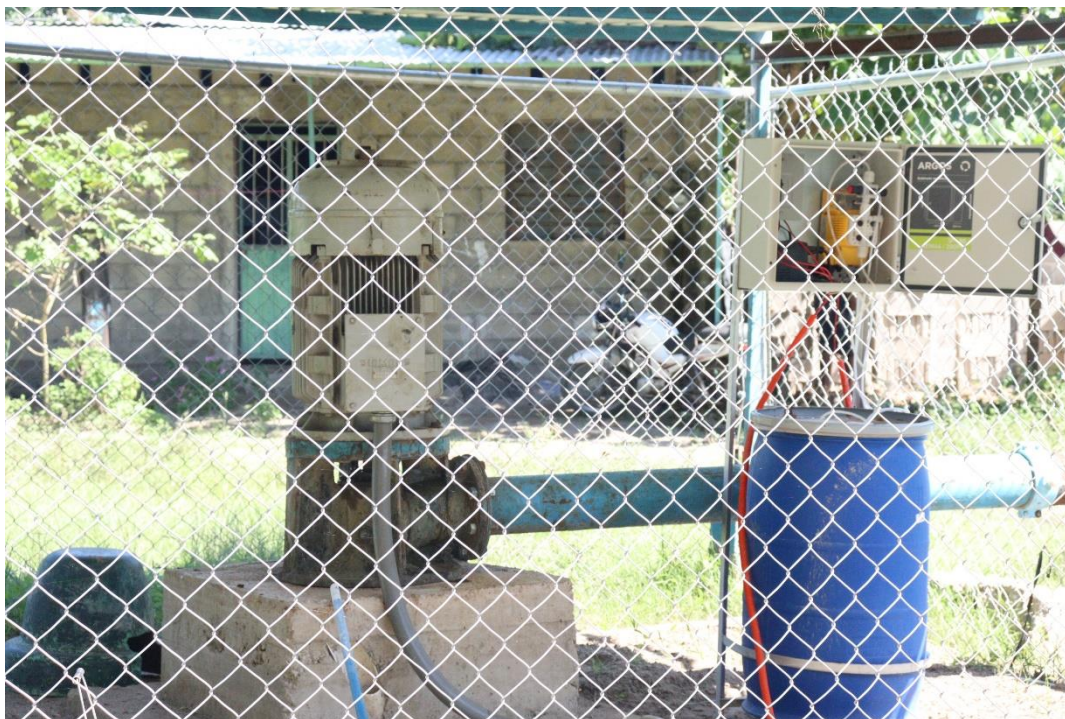
Fotografía 6. Equipo para tratamiento de agua con hipoclorito de sodio en el pozo Vista Alegre (color azul)
