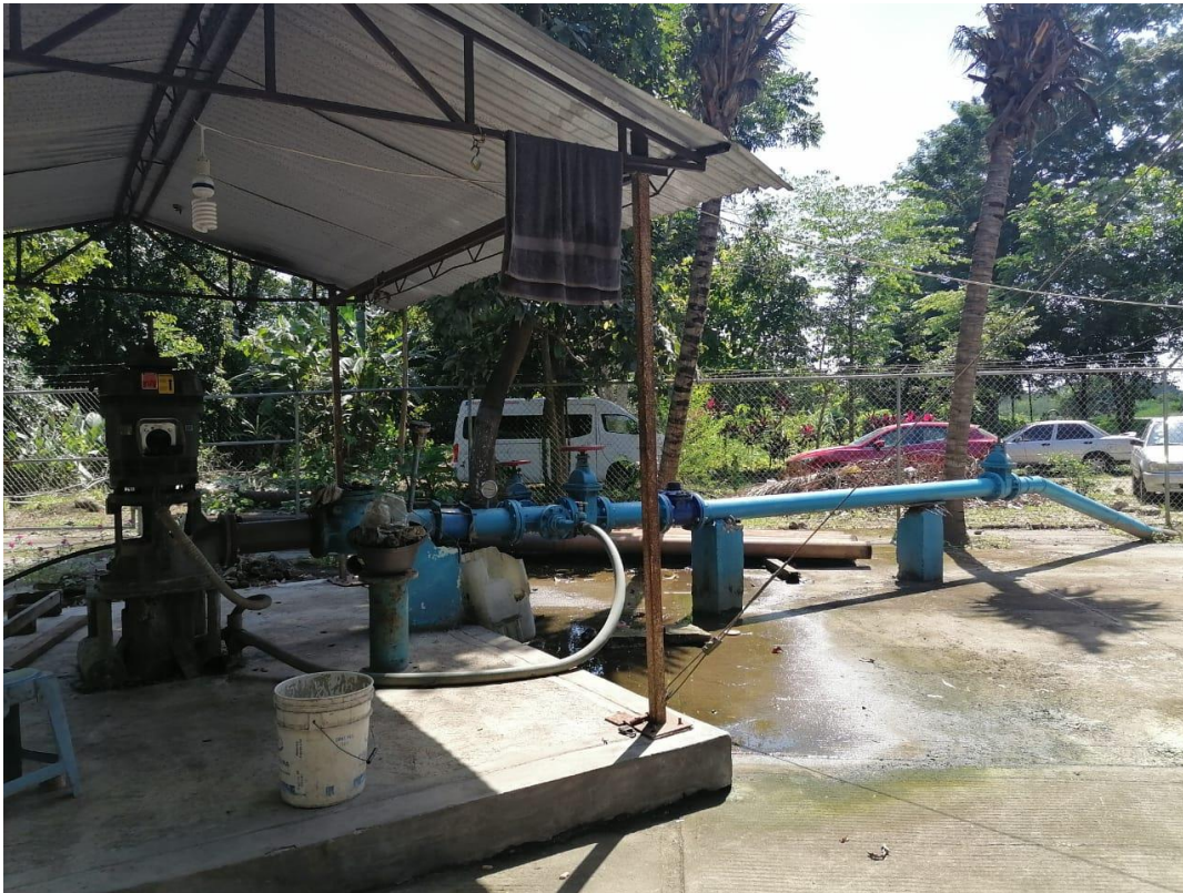
Fotografía 3. Pozo municipal CBTA
