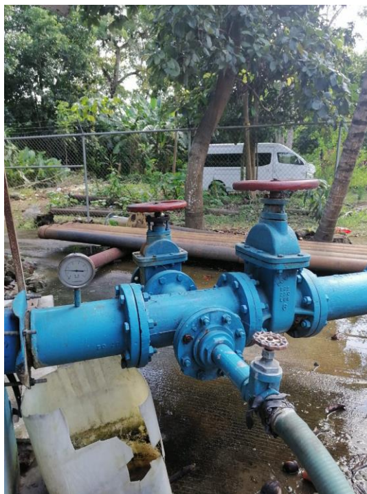
Fotografía 12. Tubería y línea de conducción del agua (pozo CBTA)
