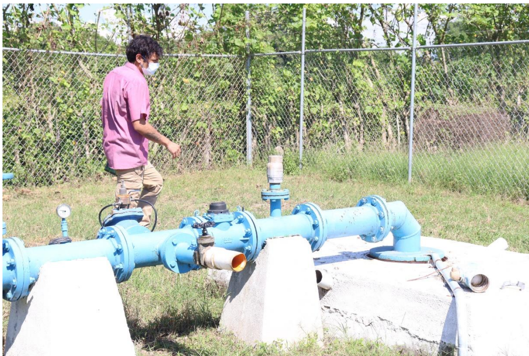
Fotografía 14. Tubería y línea de conducción (pozo Manuel Velazco Suarez)
