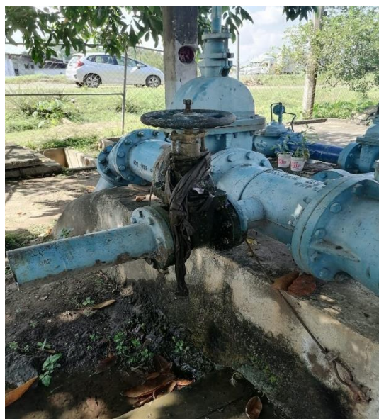
Fotografía 4. Pozo municipal Zaragoza
