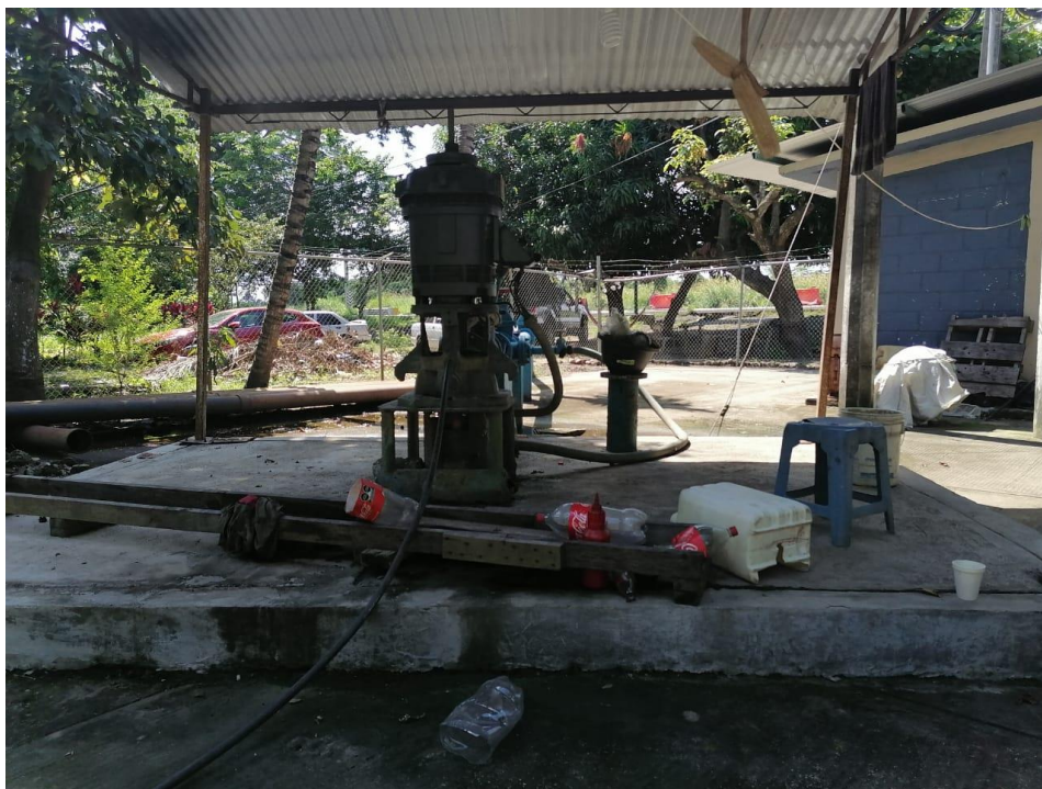
Fotografía 8. Motor vertical pozo CBTA
