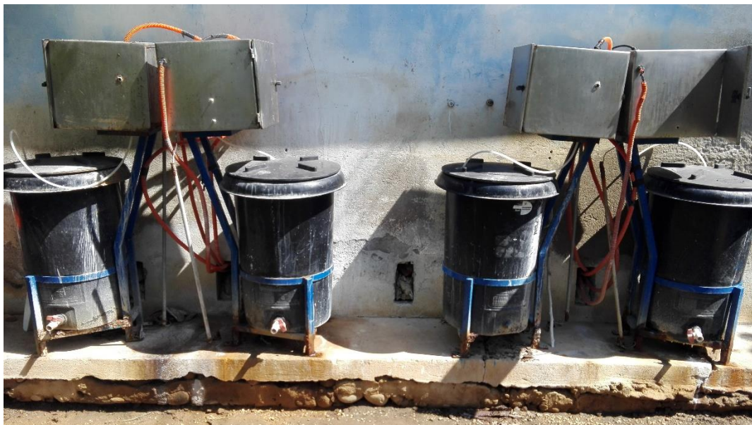
Fotografía 5. Equipo para tratamiento de agua con hipoclorito de sodio en el pozo Zaragoza
