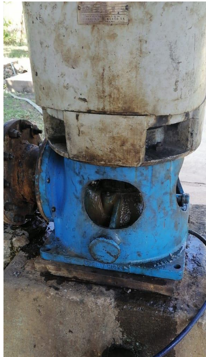
Fotografía 9. Motor vertical pozo Zaragoza
