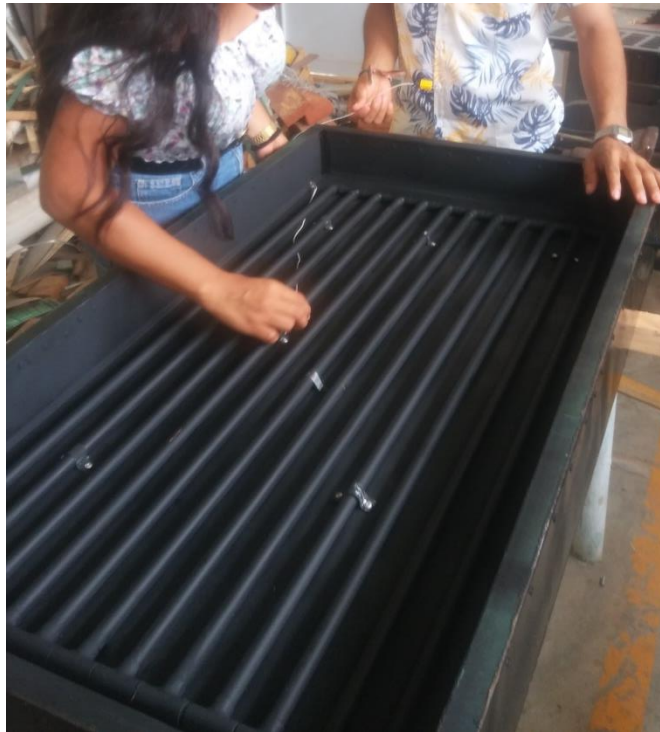
Figura 4.6. Sistema de tubería del colector solar (A. Galicia, 2019).
