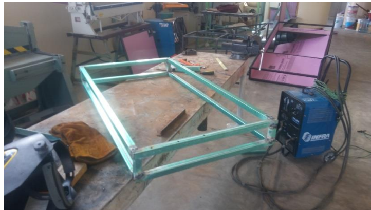
Figura 4.4. Estructura del colector solar (A. Matus, 2019).
