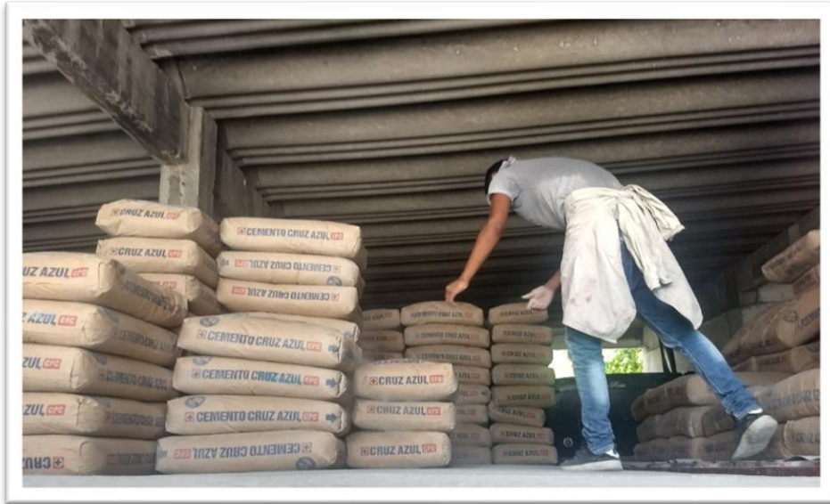
Figura 14. Uso de la fuerza física al cargar y mover los costales de cemento
