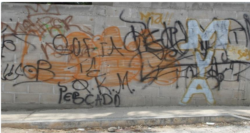
Foto No. 1 Pared de una escuela ubicada en la colonia Miravalle
