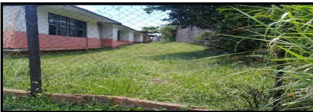
Figura 31. Instalaciones traseras exceso de maleza.
