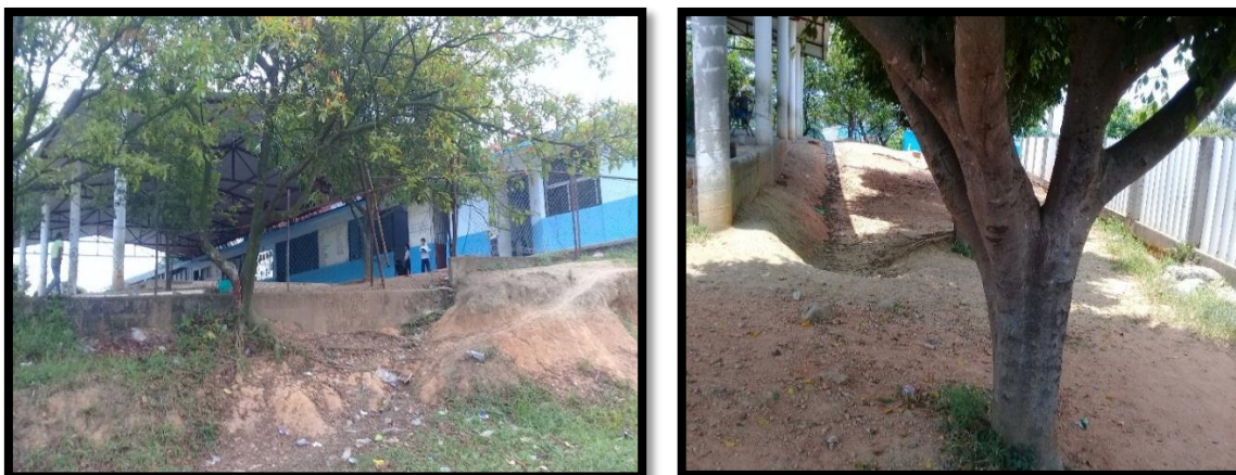
Figura 10. Terreno inestable escuela primaria Benito Juárez.
