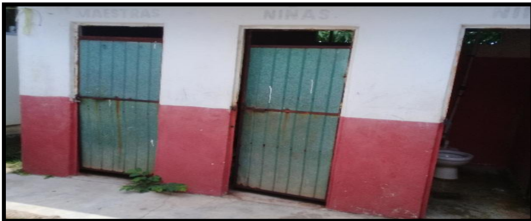
Figura 27. Baños en mal estado oxidados y deteriorados
