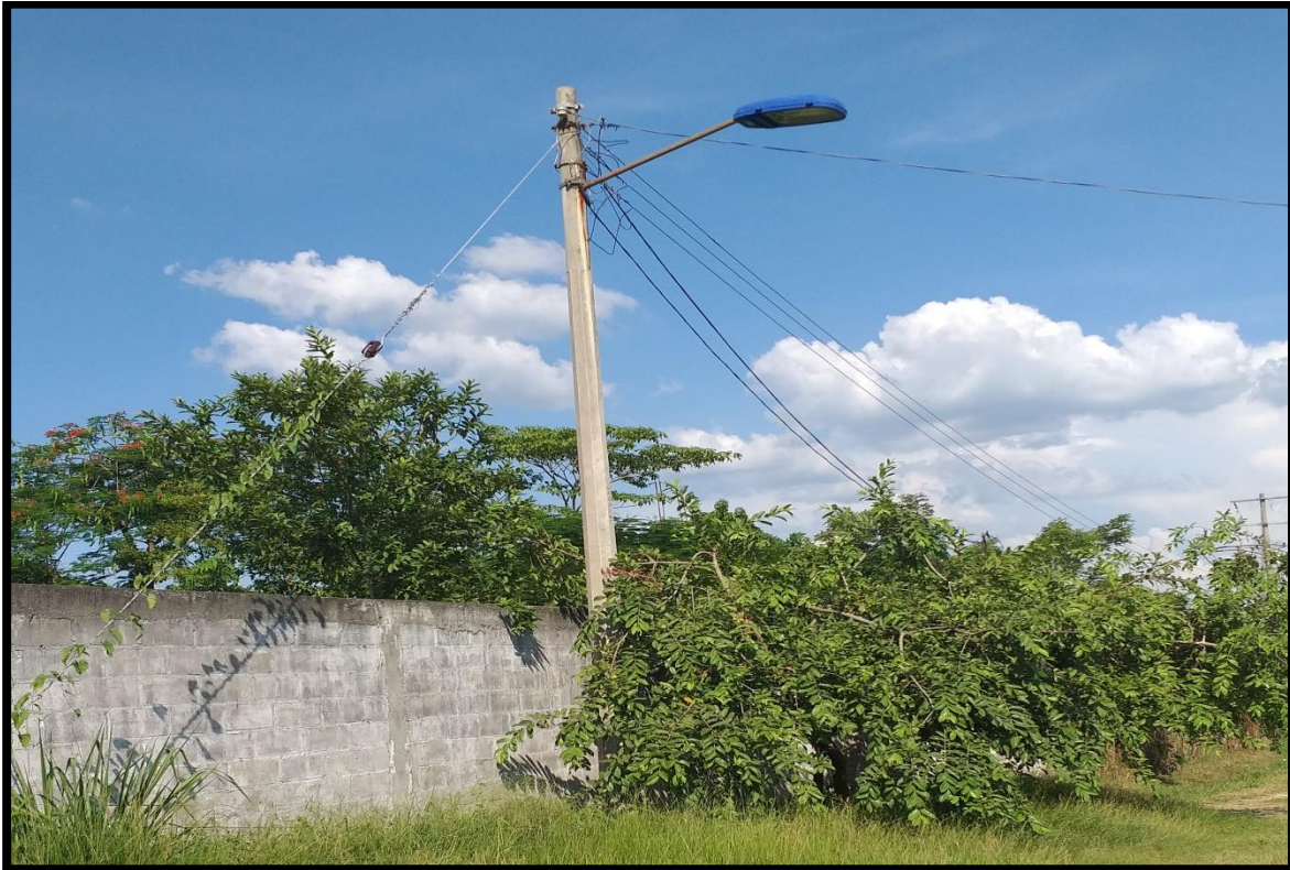
Figuran 12 Cables en malas condiciones
