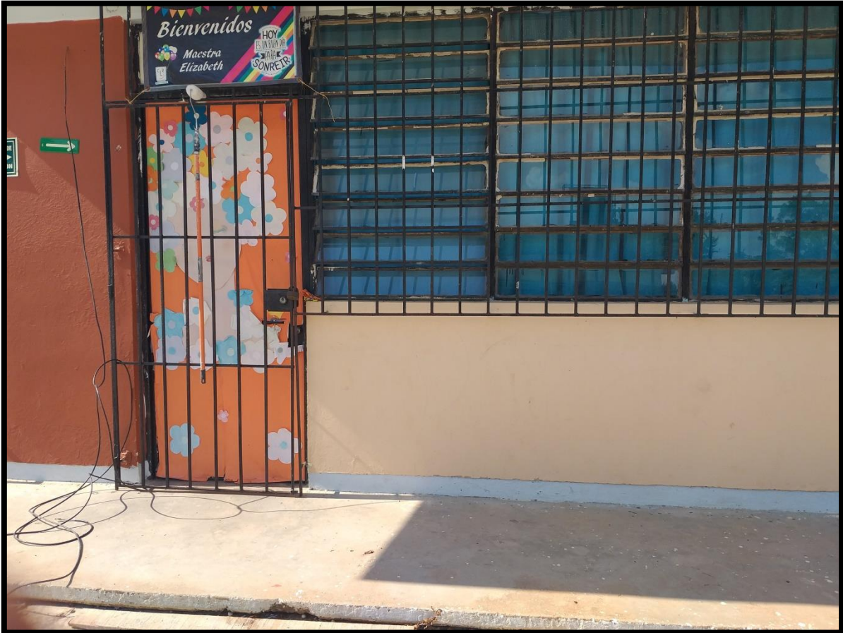
Figuran 13 Cables obstruyendo pasillo
