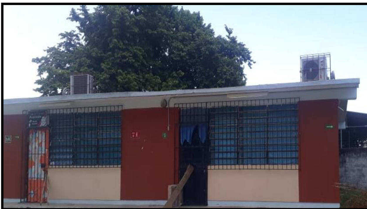
Figura 5 Malas condiciones de los señalamientos
