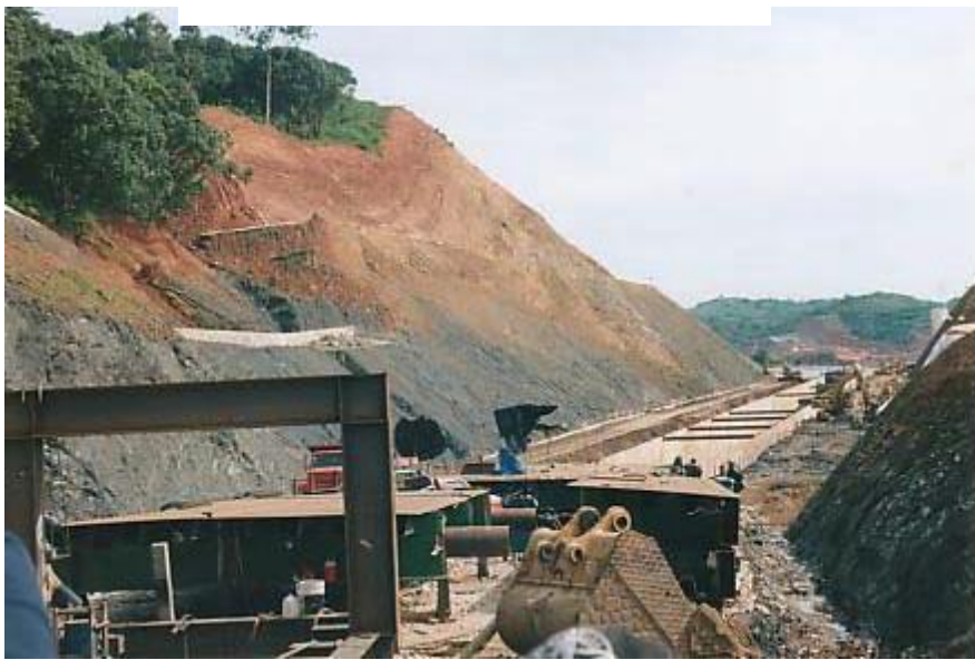
Imagen 4.3.4-3 Patio de Fabricación
