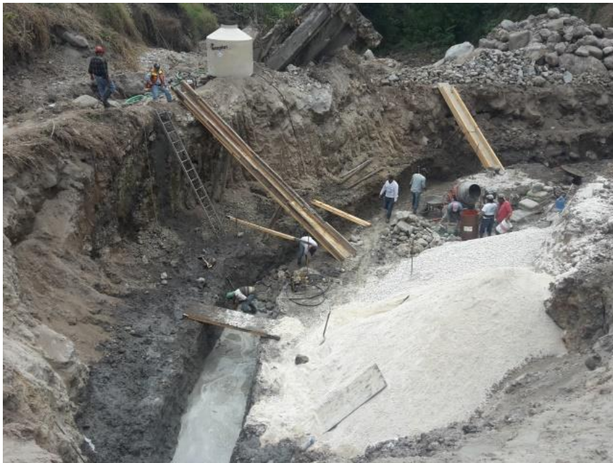
Imagen 4.1.2-3 Se observa construcción del Dentellón, una vez verificada la Excavación por la Topografía.
