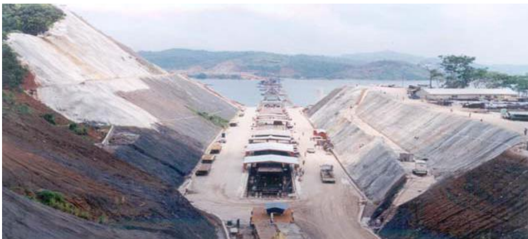
Imagen 4.3.4-4 Patio de Fabricación
