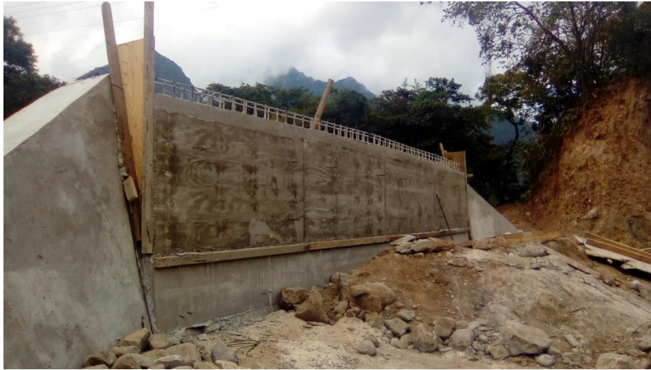
Imagen 4.1.6-5 Cimbrado y colado de Muro de Respaldo, respecto a Trazo y Niveles.
