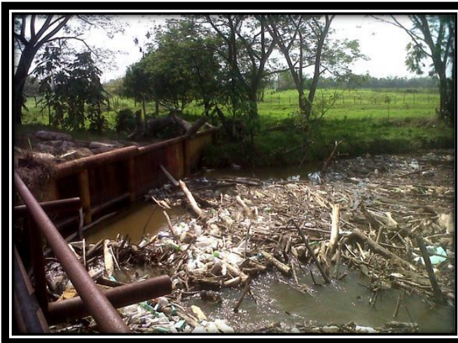
Ilustración 23 Tapón de Basura Orgánica Ubicado en el Puente Tubular Sin Nombre en el Ejido Santa Cruz Tepate Abajo
