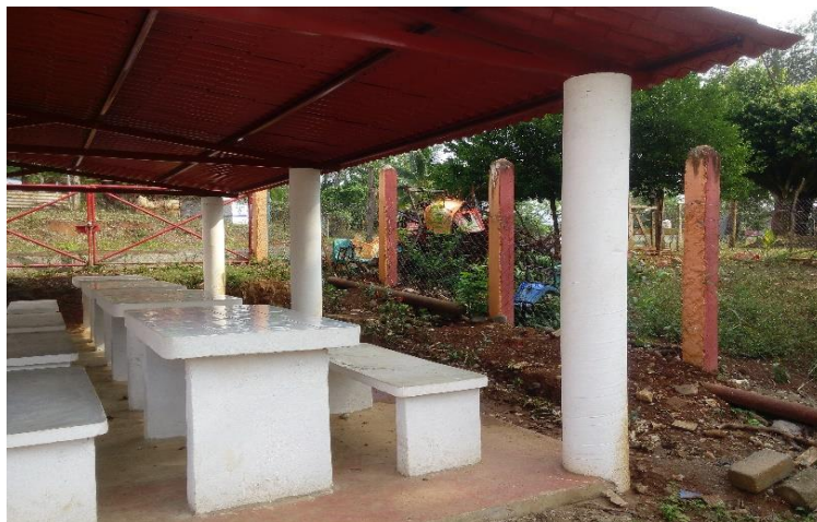
Figura No. 8 Escombros a un lado de los desayunadores de la telesecundaria No. 537
