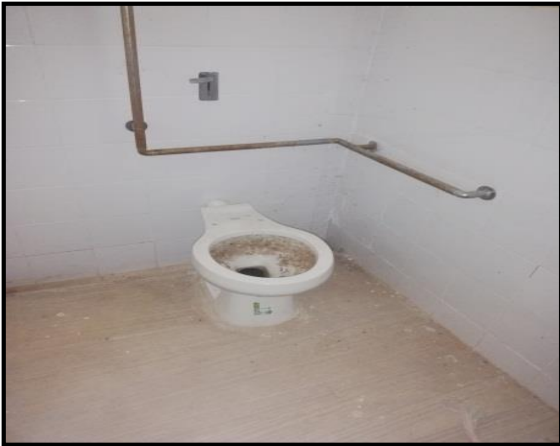
Figura 15 Baño en malas condiciones Fuente: en base a la información obtenida
