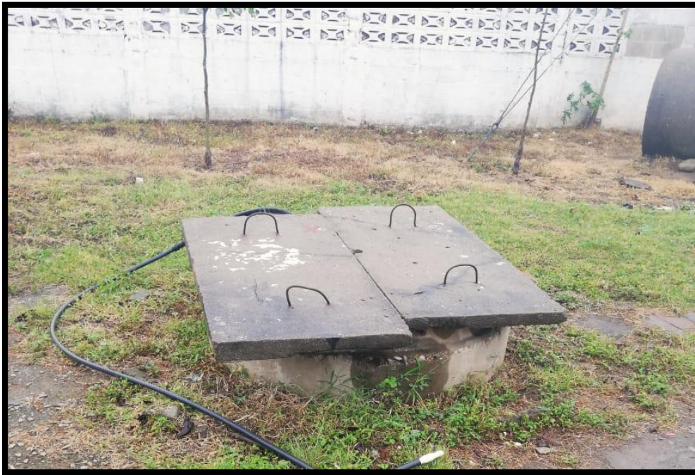
Figura 8 Pozo. Fuente: con base a la información obtenida
