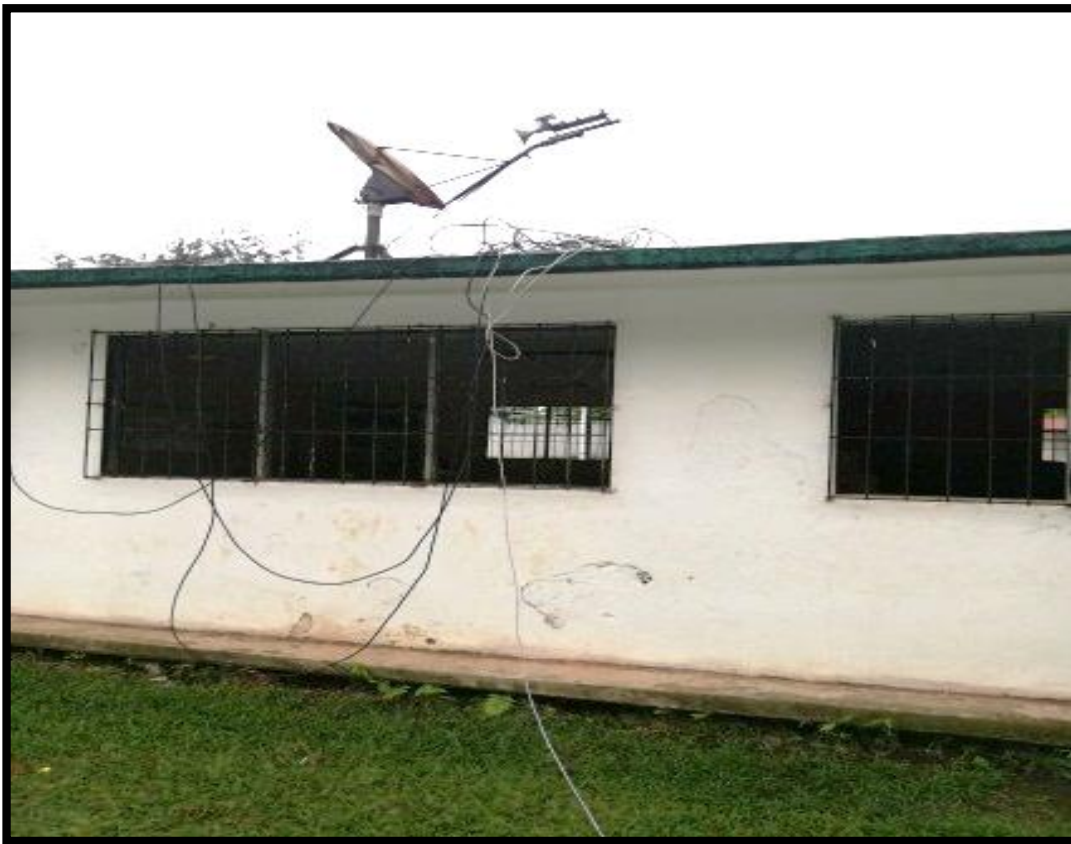
Figura 17 Mala instalación del bajante. Fuente: en base con la información obtenida
