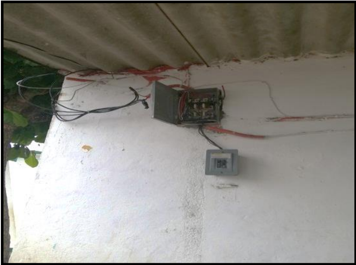
Figura 14 Mala Conexión e Instalación Fuente: en base a la información obtenida
