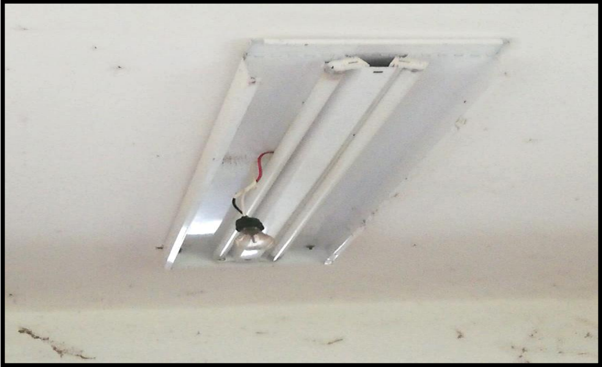
Figura 23 Lámpara en mal estado. Fuente: con base a la información obtenida
