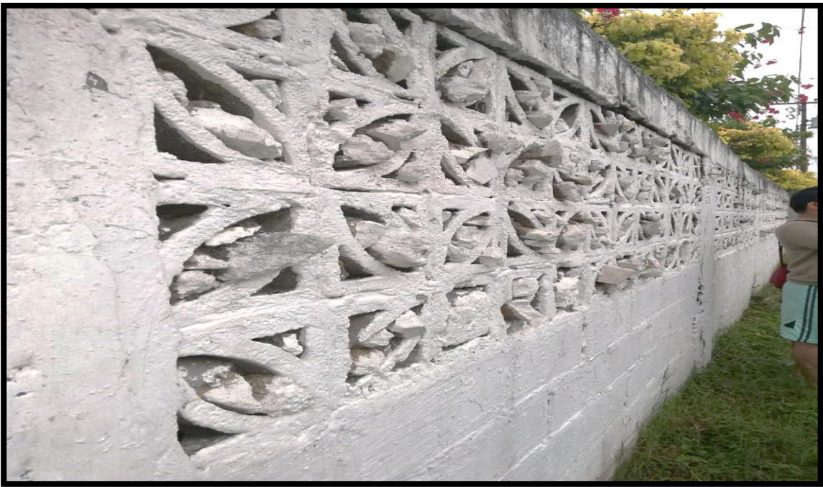
Figura 24 Barda en mal estado. Fuente. con base a la información obtenida
