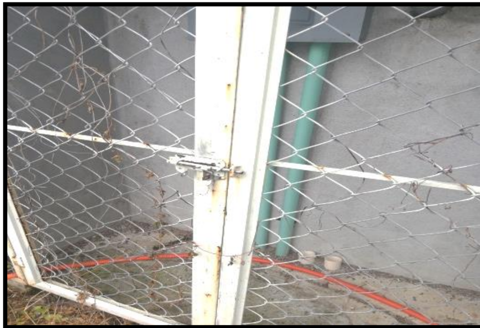
Figura 13 Bajantes Inadecuados De Luz. Fuente: en base a la información obtenida
