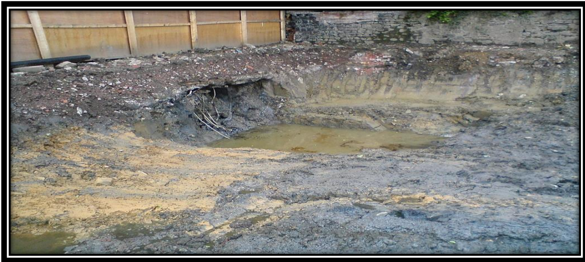
Figura. 3 Contaminación del suelo causada por depósitos subterráneos.
