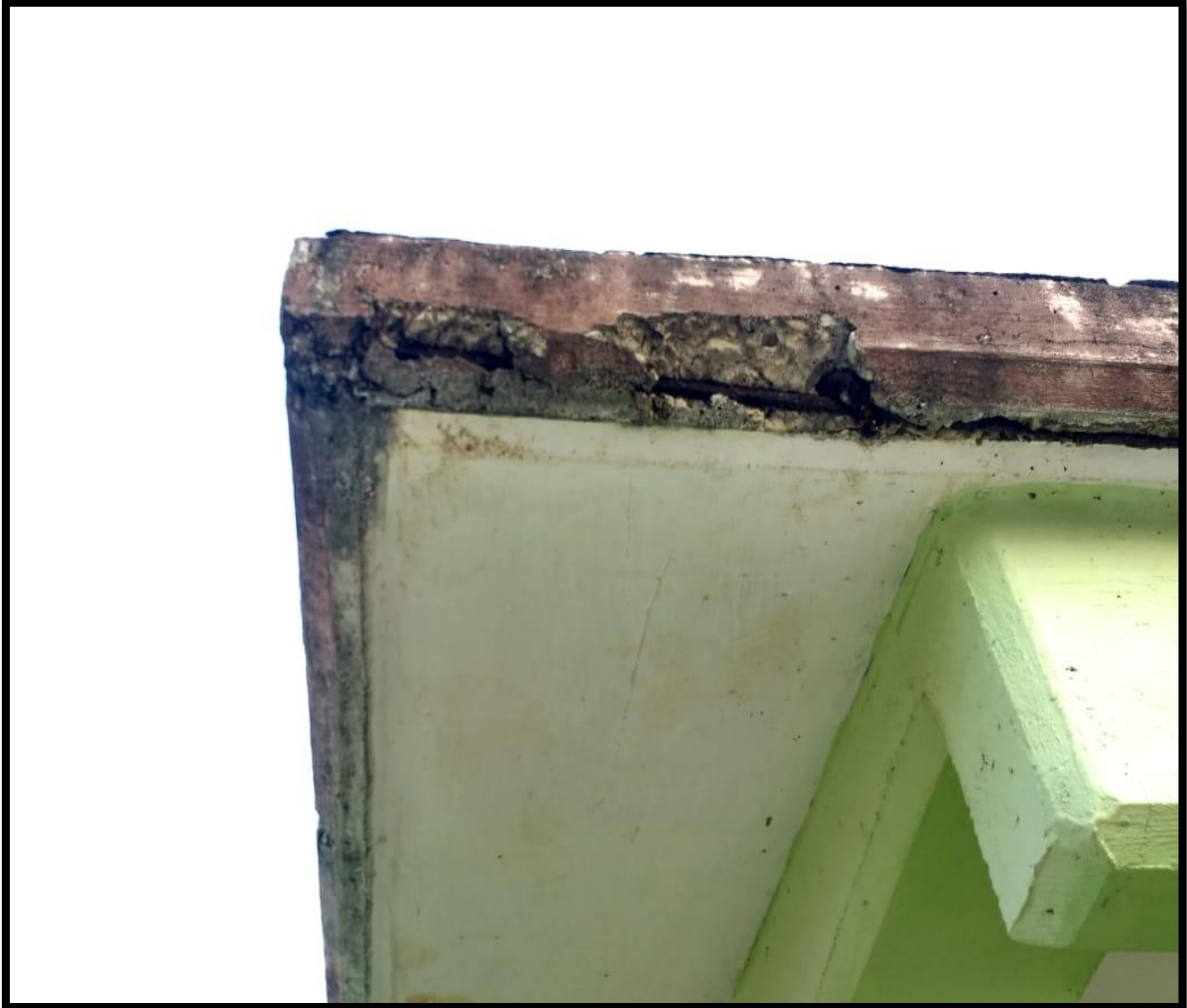
FIGUR 18 Infraestructuras en deterioro FUENTE en base en la información obtenida
