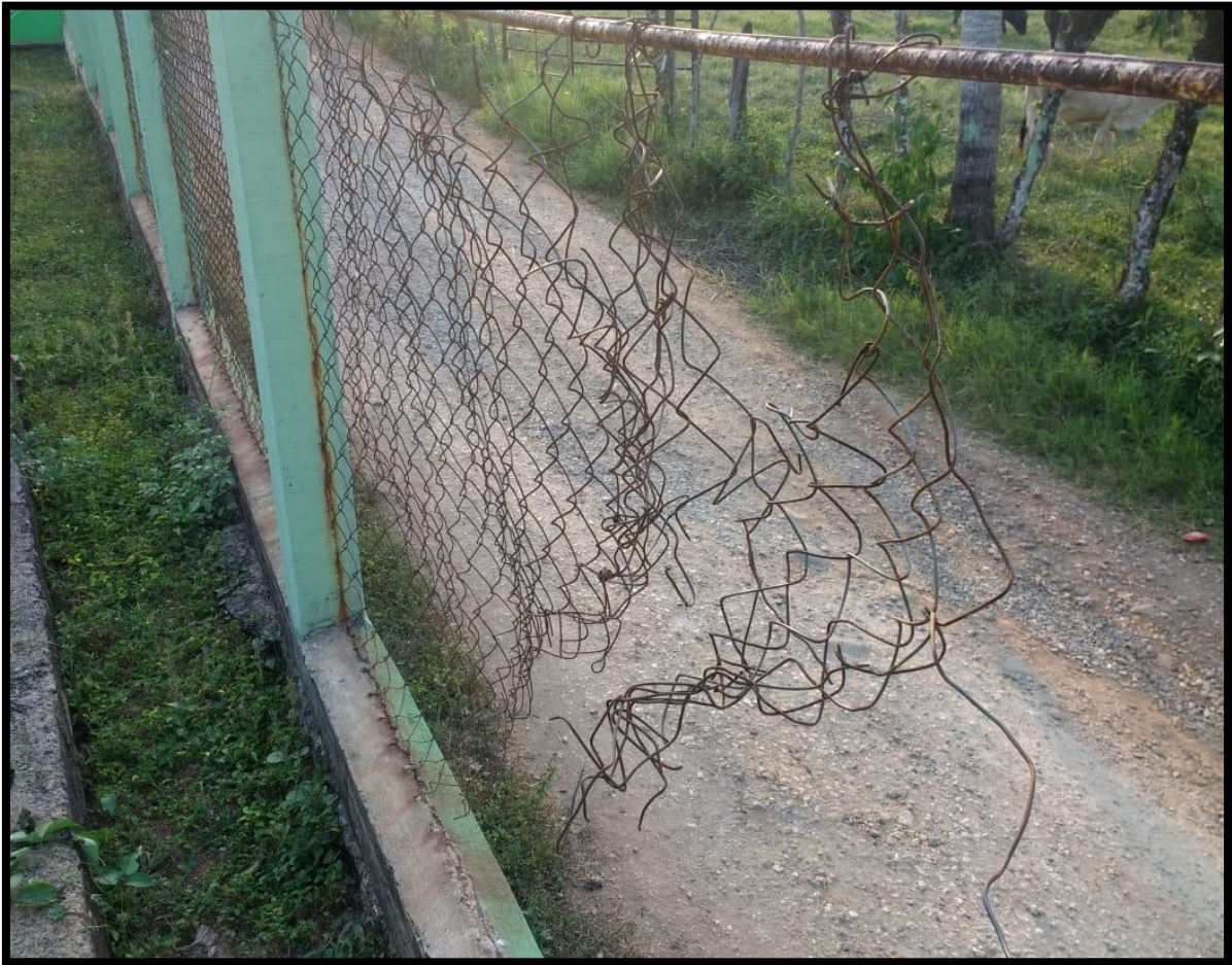
FIGURA 10 Enmallado en mal estado FUENTE en base a la información obtenida
