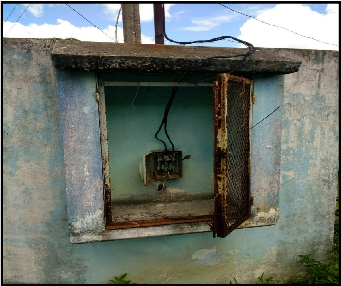
FIGURA 14 Cableado eléctrico en mal estado FUENTE en base en la información obtenida
