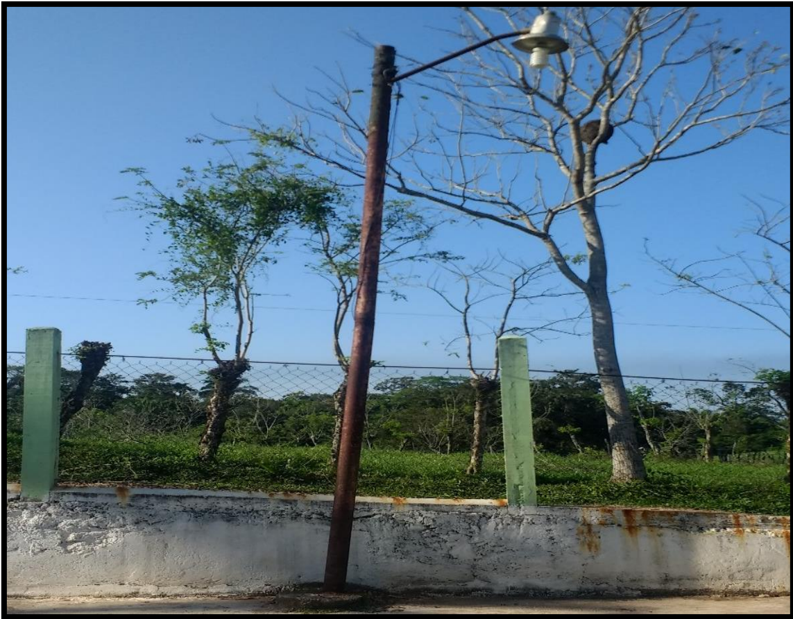
FIGURA 11 Poste metálico en mal estado FUENTE en base a la información obtenida
