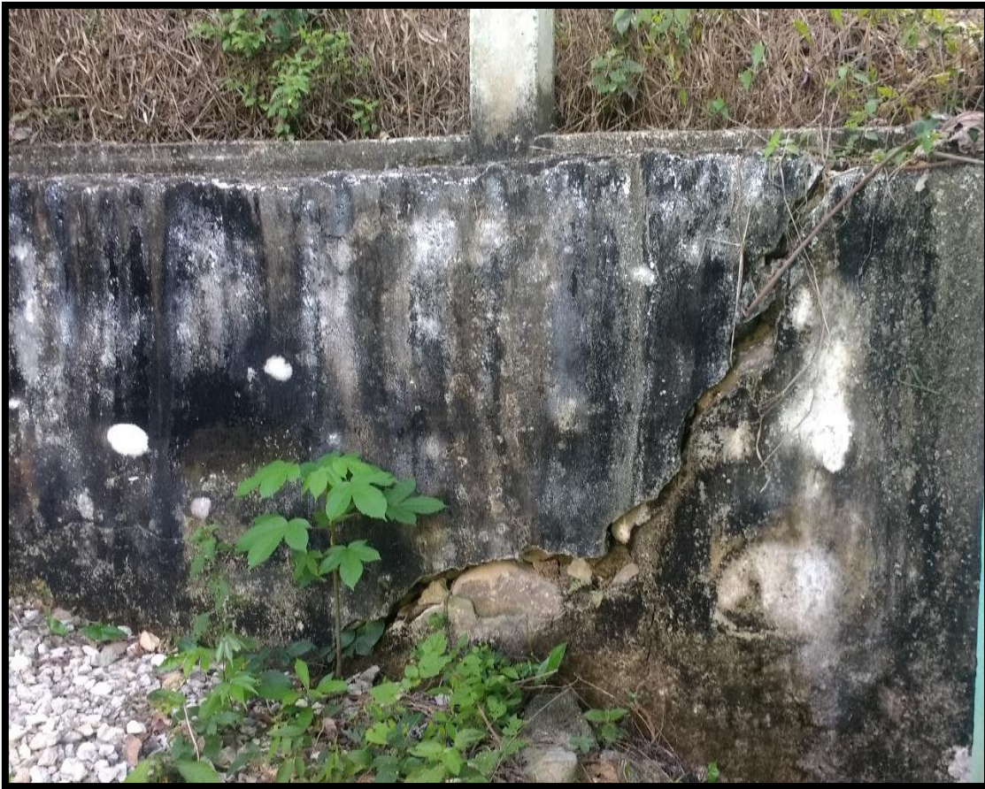
FIGURA 12 Barda de retención de tierra en mal estado FUENTE en base en la información obtenida
