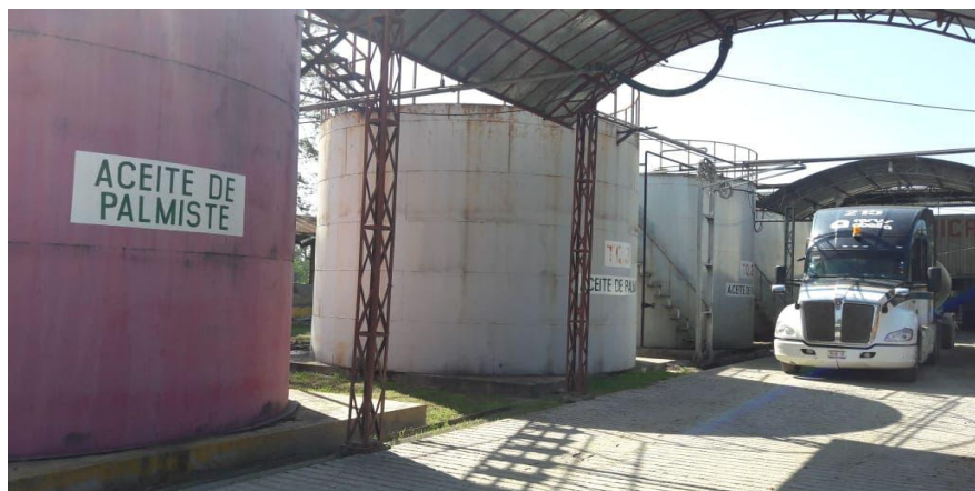
Figura 8. Tanques de almacenamiento de aceite (Tecuautzin, 2018).
