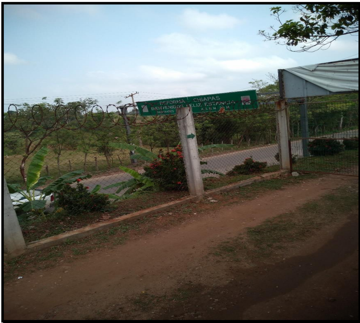
Imagen 8. Mallas en mal estado
