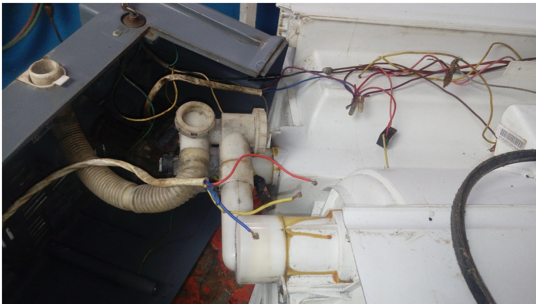
Figura-15 Cables sueltos
