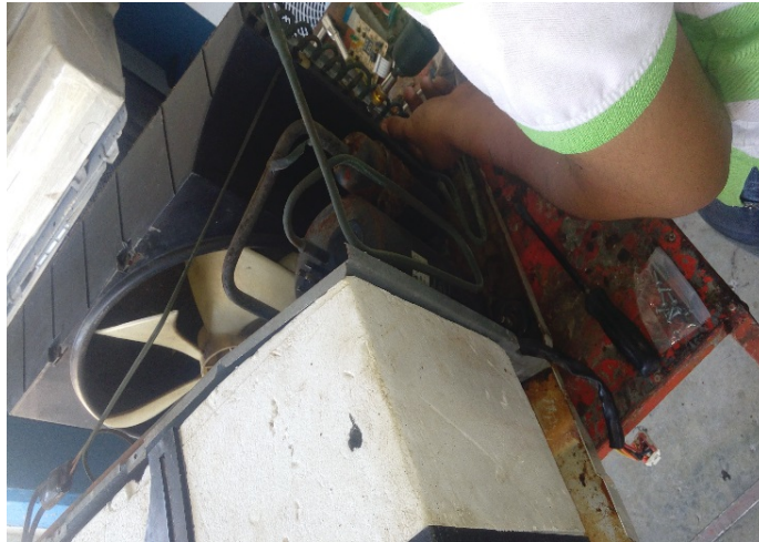
Figura-9 Aire acondicionado de ventana
