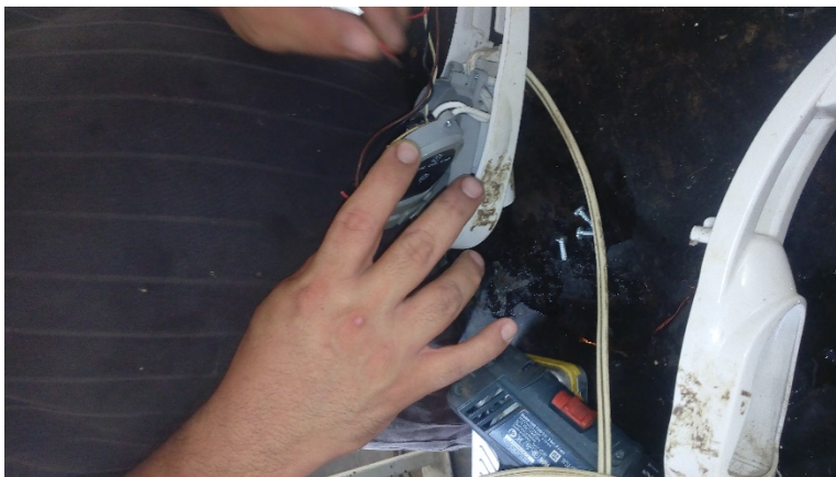
Figura-13 servicio a ventilador
