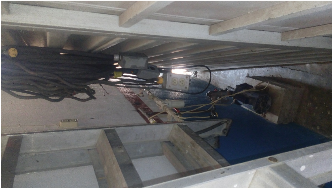
Figura-22 Cables sueltos
