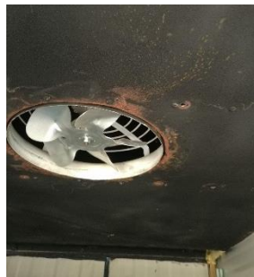
Figura 3.2 Ventilador de techo.
