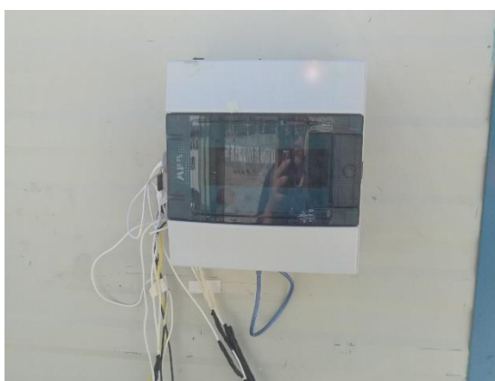
Figura 4.1 SAC instalado en Secador Solar.
