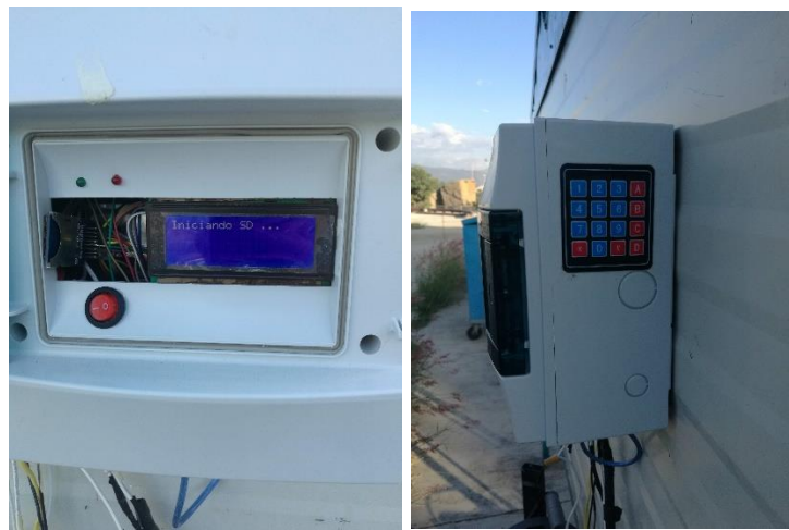
Figura 4.6 SAC instalado y operando en Secador solar.
