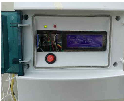
Figura 4.2 LED rojo encendido. indicando que existe algún problema en el SAC, LED verde encendido mostrando que el SAC está funcionando de manera correcta.
