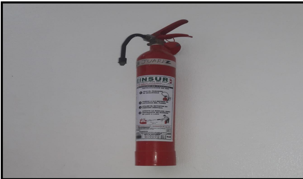
Figura 16. Extintor mal colocado
