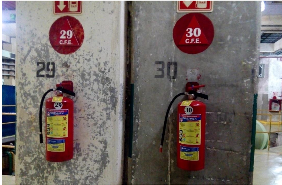
Figura 14 Extintores en piso de turbinas
