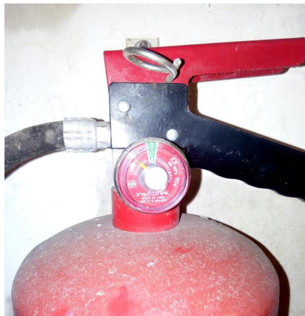
Figura 13 Extintor con falta de mantenimiento
