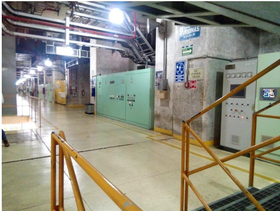
Figura 12 Tableros de control en piso de turbinas
