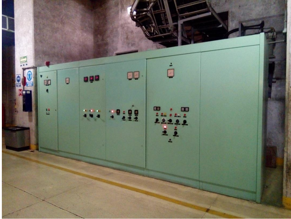
Figura 11 Tablero regulador de velocidad y PLC
