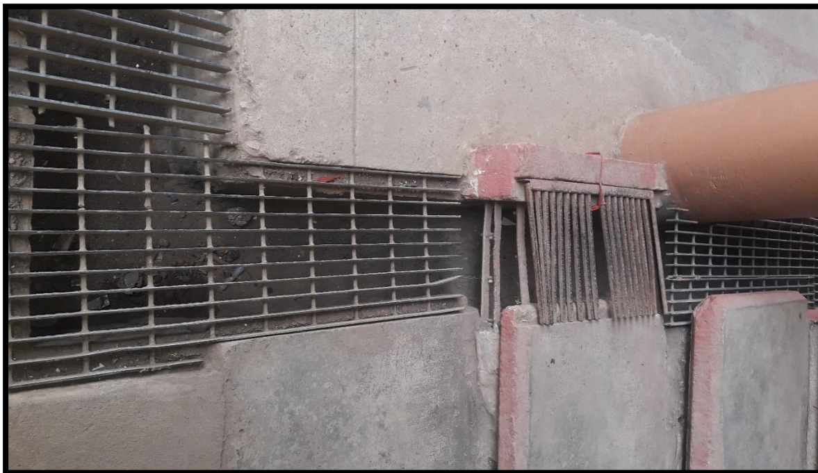
Figura 27 Trincheras deterioradas por la corrosión.
