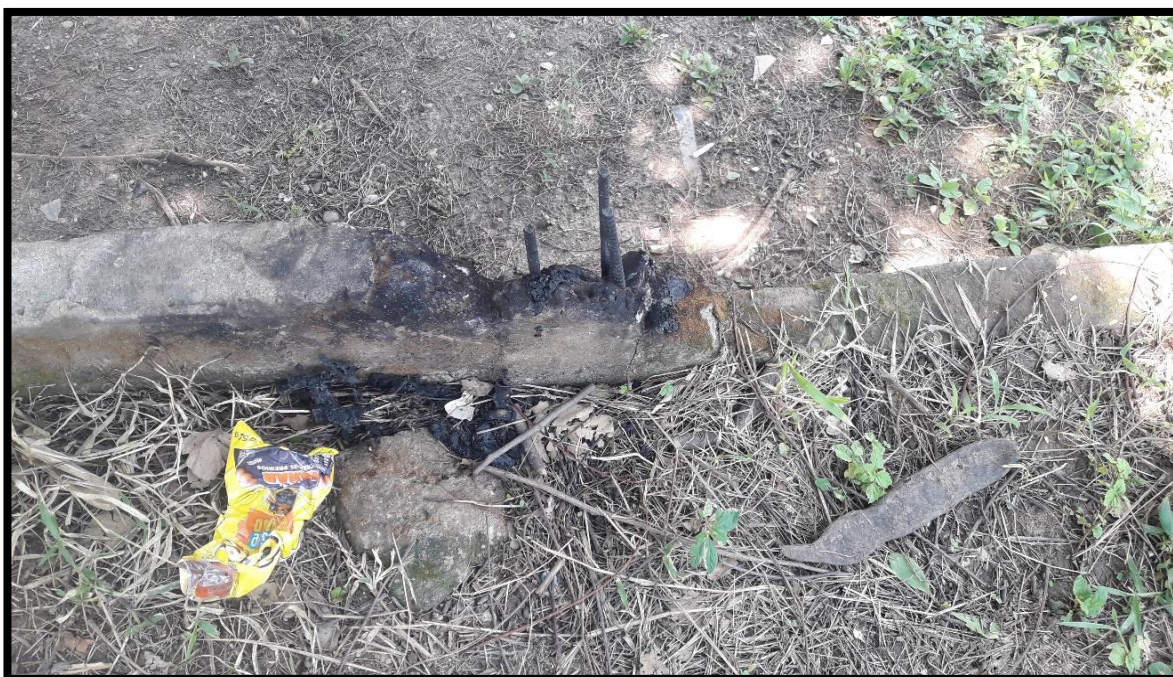
Figura 26 Varillas a la intemperie en una barda perimetral de un metro de alto.
