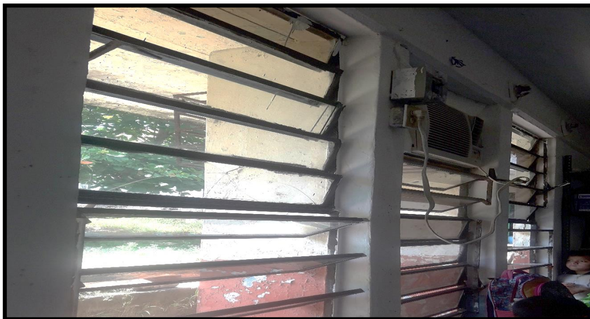
Figura 25 Ventanas con vidrios rotos.
