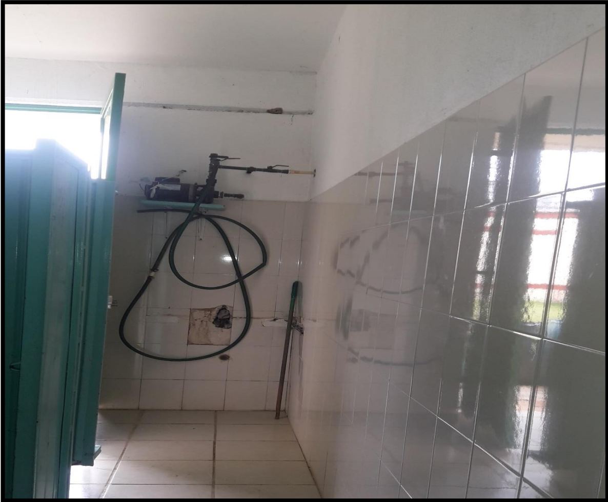
Figura 21 Bomba de agua.
