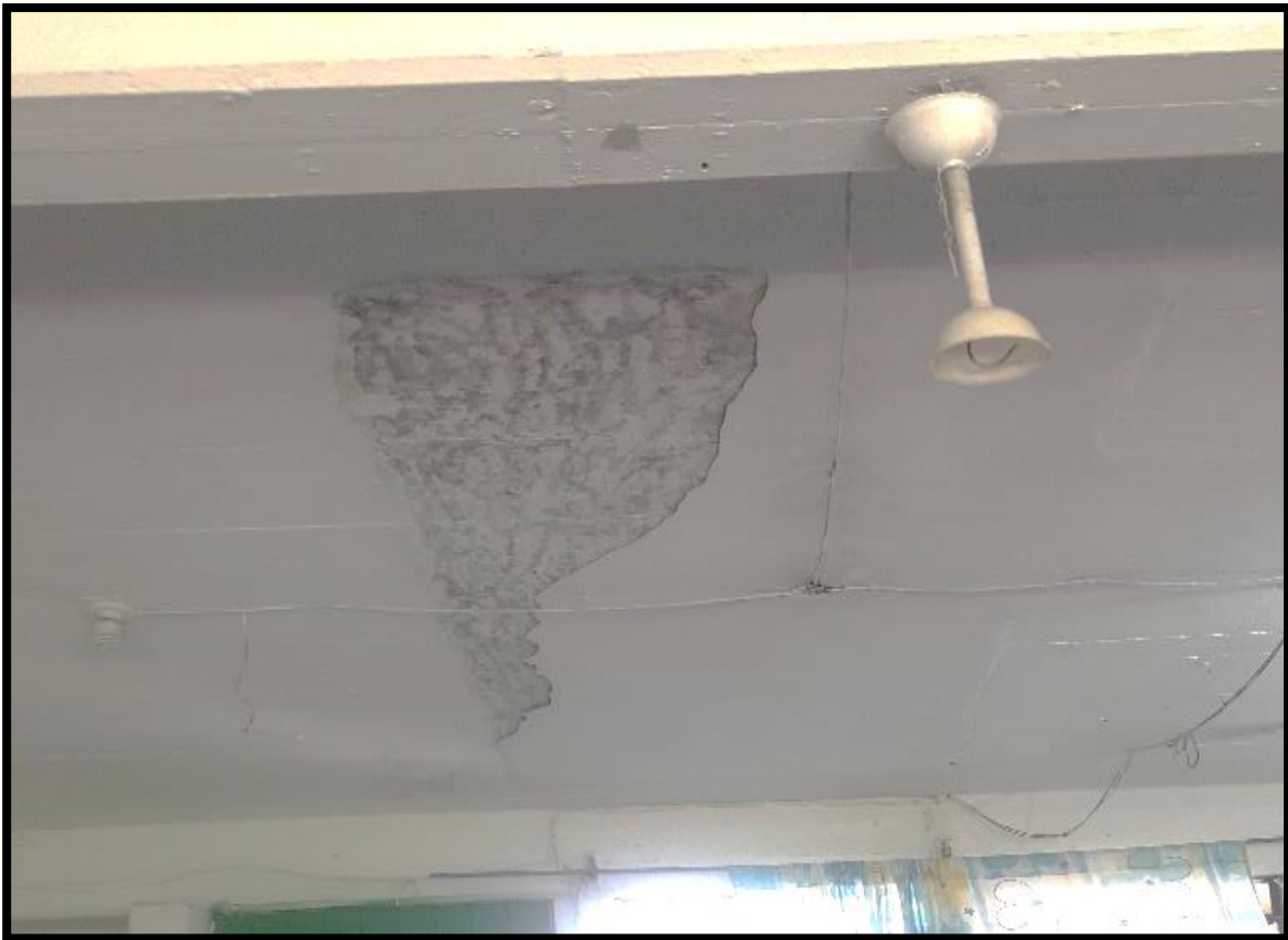
Figura 8 Humedad en el techo.
