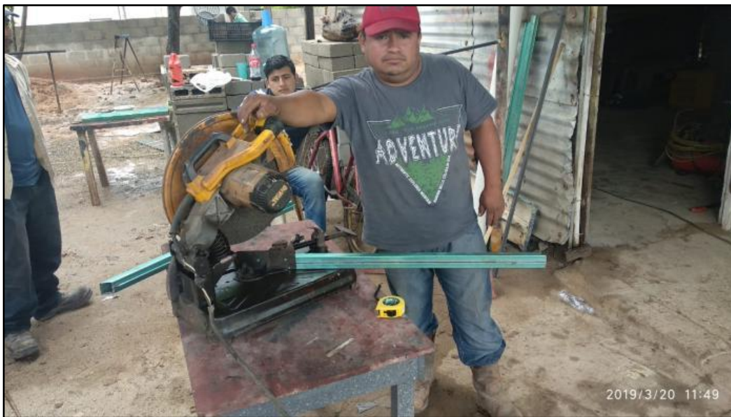
Ilustración 23 Herrería "El Tarta", trabajador sin el equipo de protección personal para utilizar la sierra. Fuente: Con base a la información obtenida
