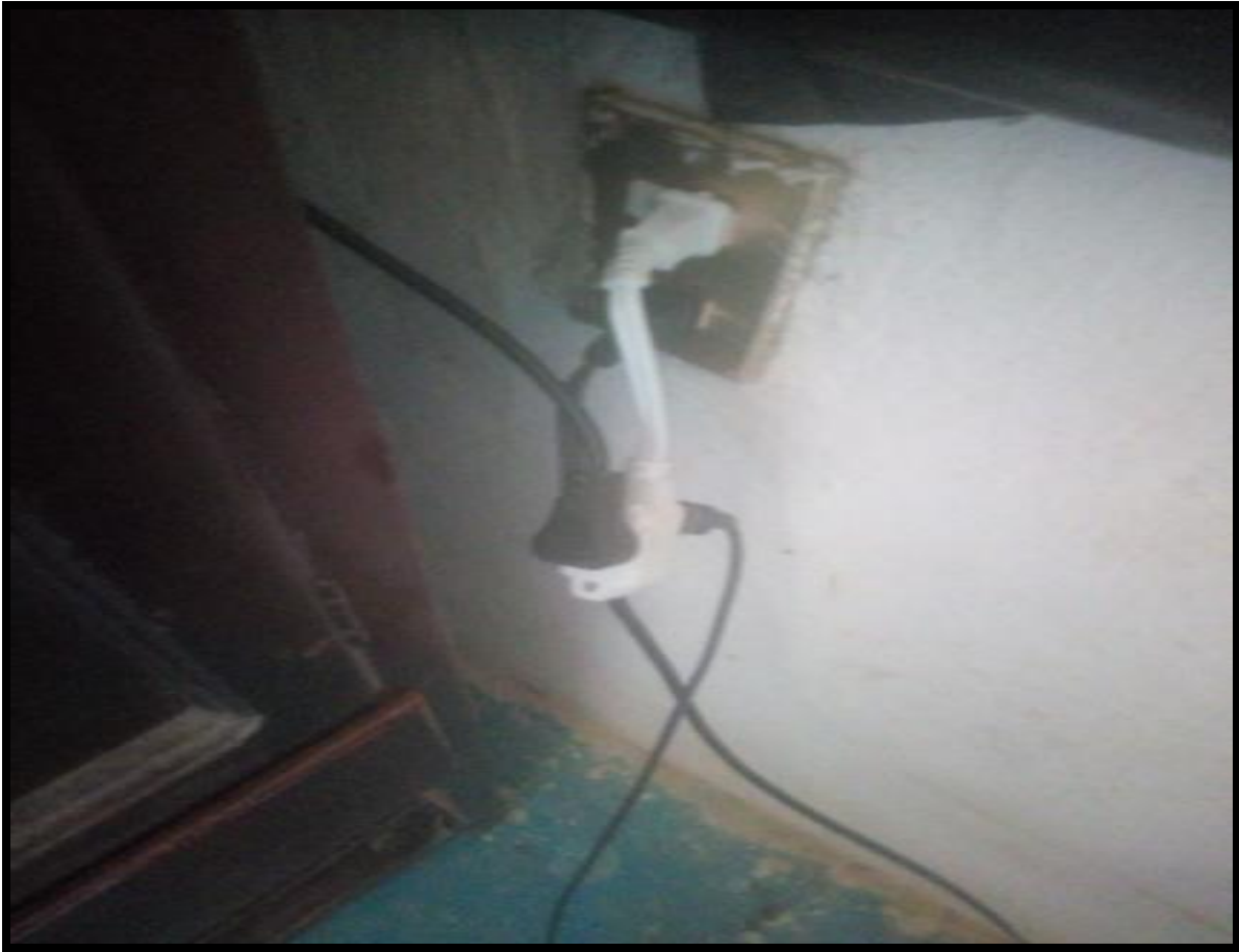
Figura 21. Identificación de Riesgo por Incendio en la Col. Francisco Villa Fuente: Con Base a la Información Obtenida
