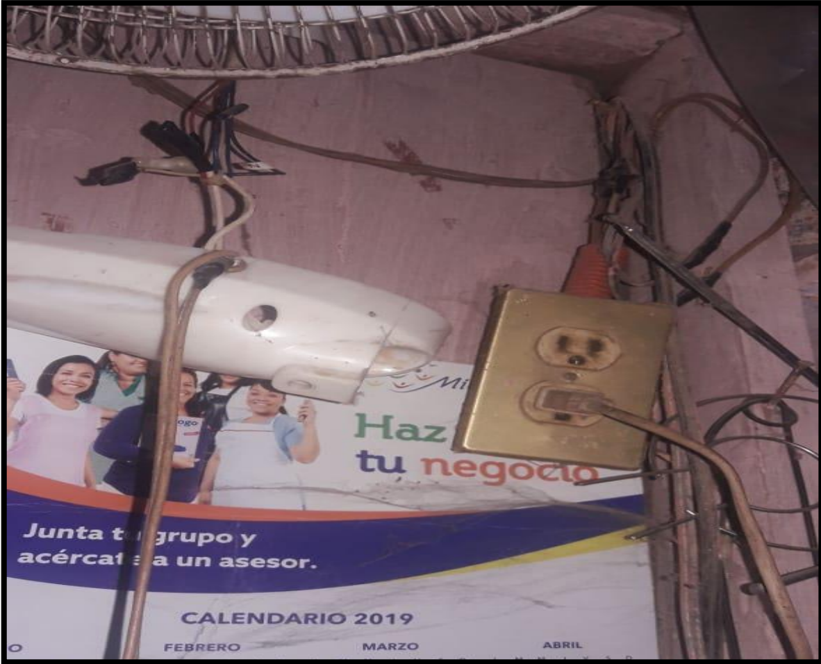
Figura 37. Identificación de Riesgo por Incendio en la Col. Benito Juárez Fuente: Con Base a la Información Obtenida
