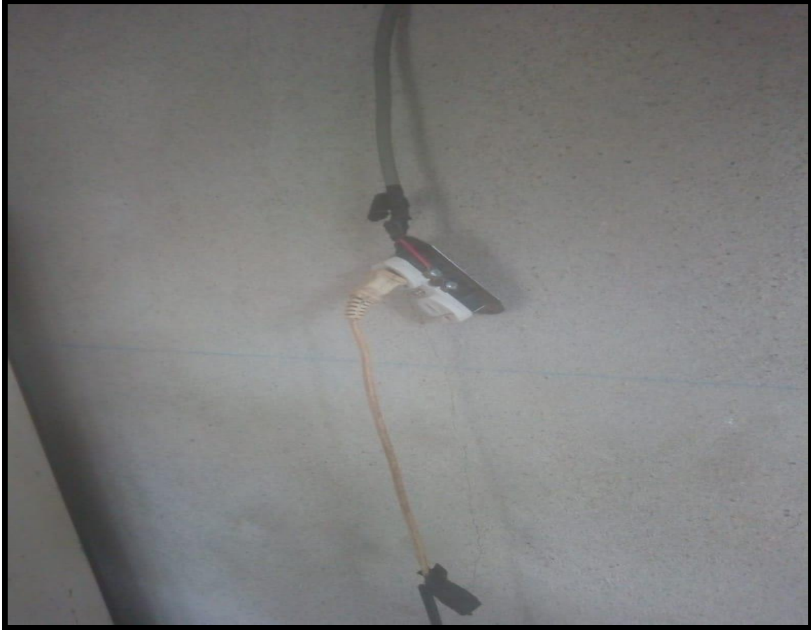
Figura 20. Identificación de Riesgo por Incendio en la Col. Buena Vista Fuente: Con Base a la Información Obtenida
