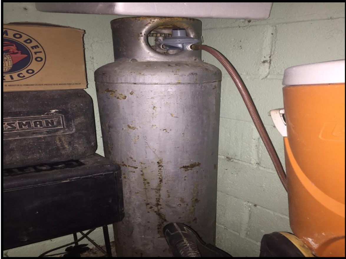
Figura 38. Identificación de Riesgo por Incendio en la Col. Benito Juárez Fuente: Con Base a la Información Obtenida
