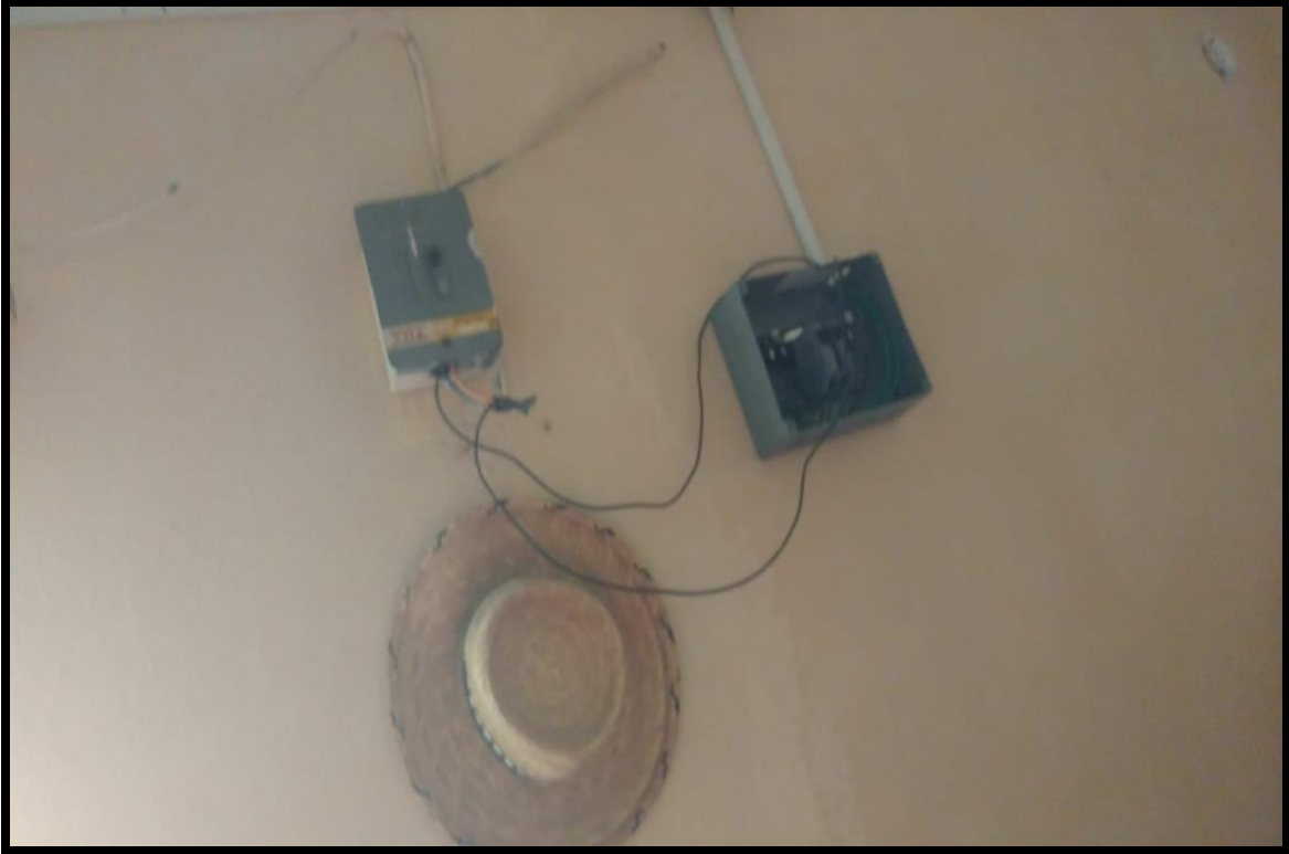
Figura 24. Identificación de Riesgo por Incendio en la Col. la Zavala Fuente: Con Base a la Información Obtenida
