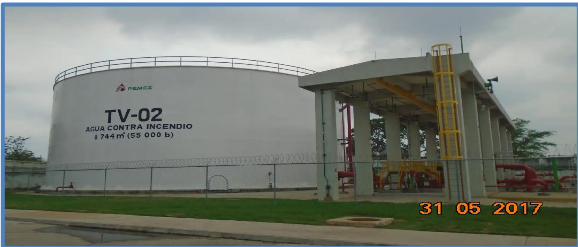
Figura 6. Almacenamiento de agua red contra incendio
