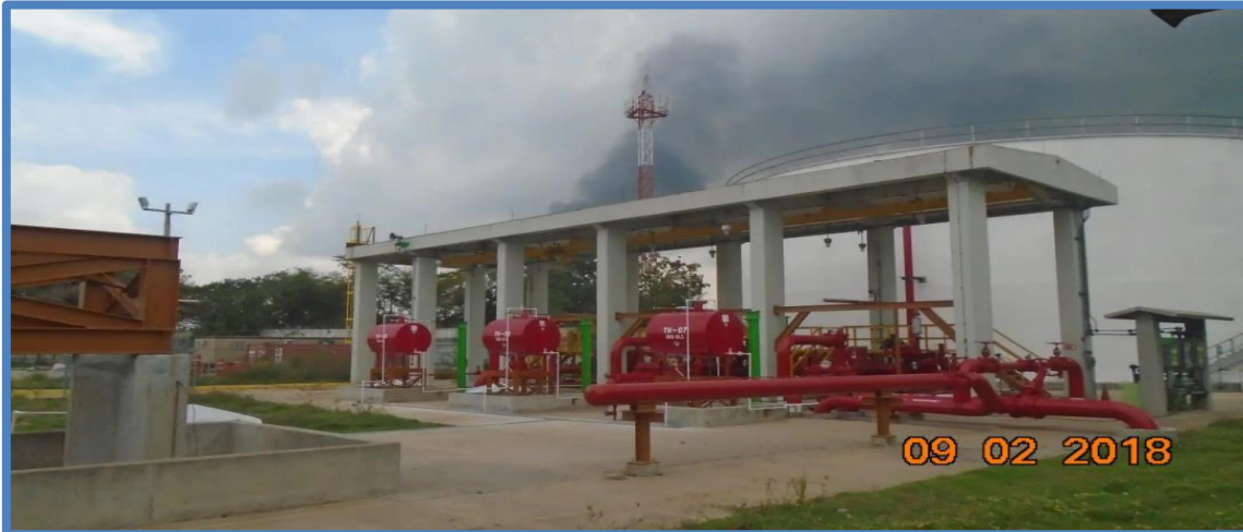
Figura 7. Casa de bombas Gas L.P
