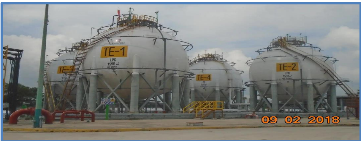
Figura 8. Almacenamiento de Gas L.P
