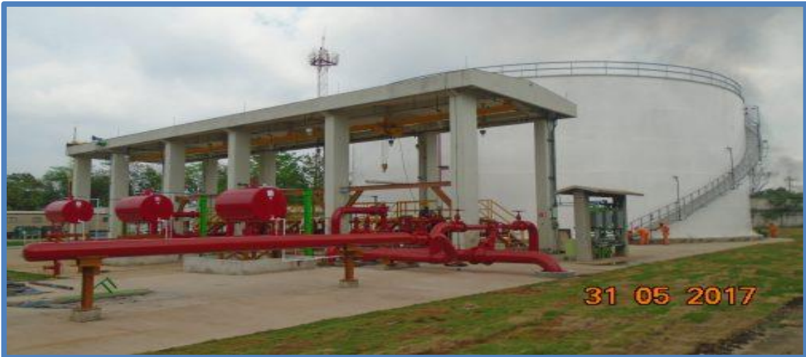
Figura 13. Casa de bombas
