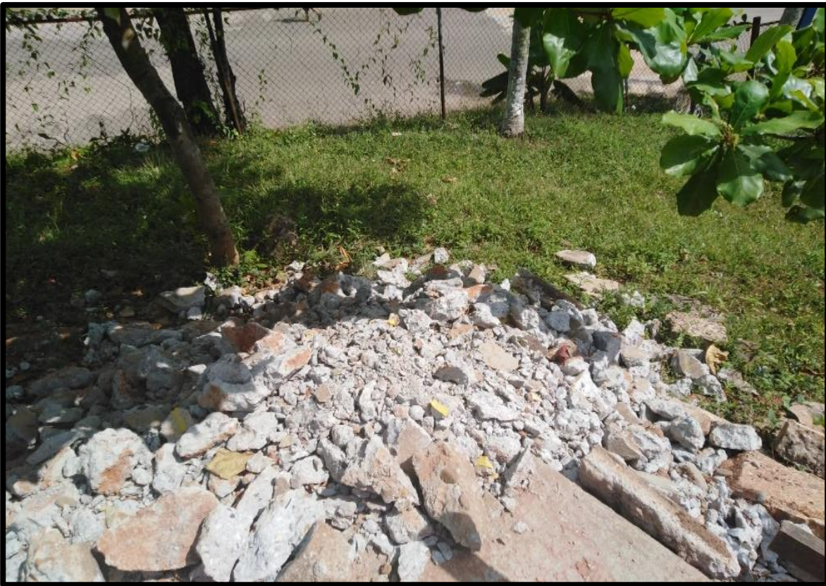
Figura 16. Escombros dentro de la instalación. Fuente: con base a la información obtenida.
