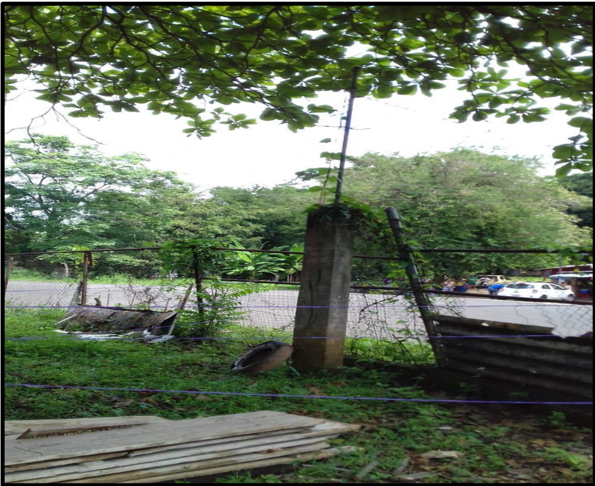
Figura 14. Mufa en mal estado. Fuente: con base a la información obtenida.
