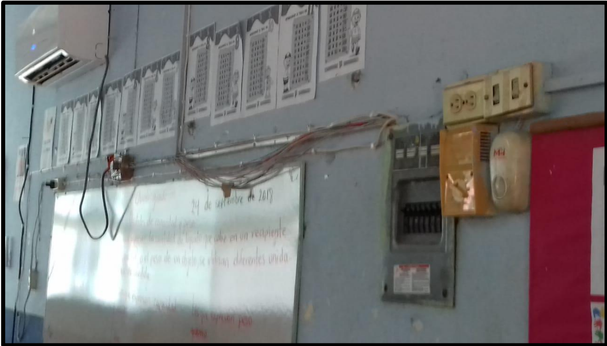
Figura 8. Cableado eléctrico de las instalaciones. Fuente: con base a la información obtenida.
