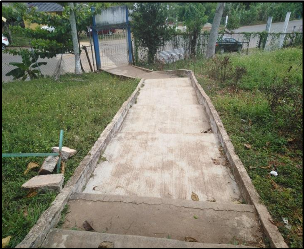
Figura 10. Condiciones de las escaleras. Fuente: con base a la información obtenida.
