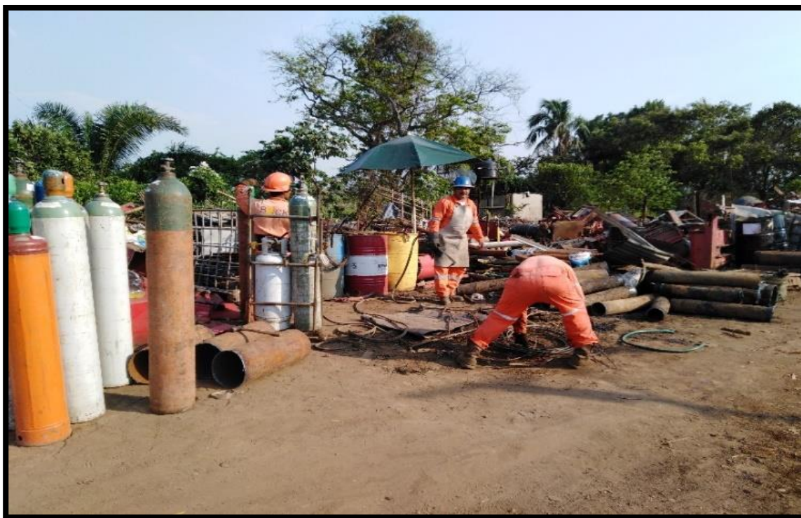
Figura 32 Falta de EPP
