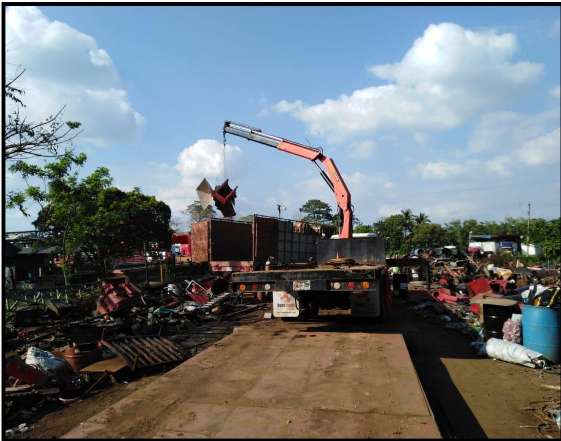
Figura 33. Falta de mantenimiento 1
