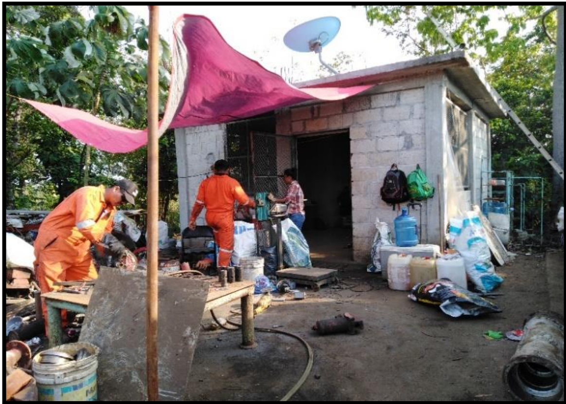
Figura 31 Desorden en el área de trabajo
