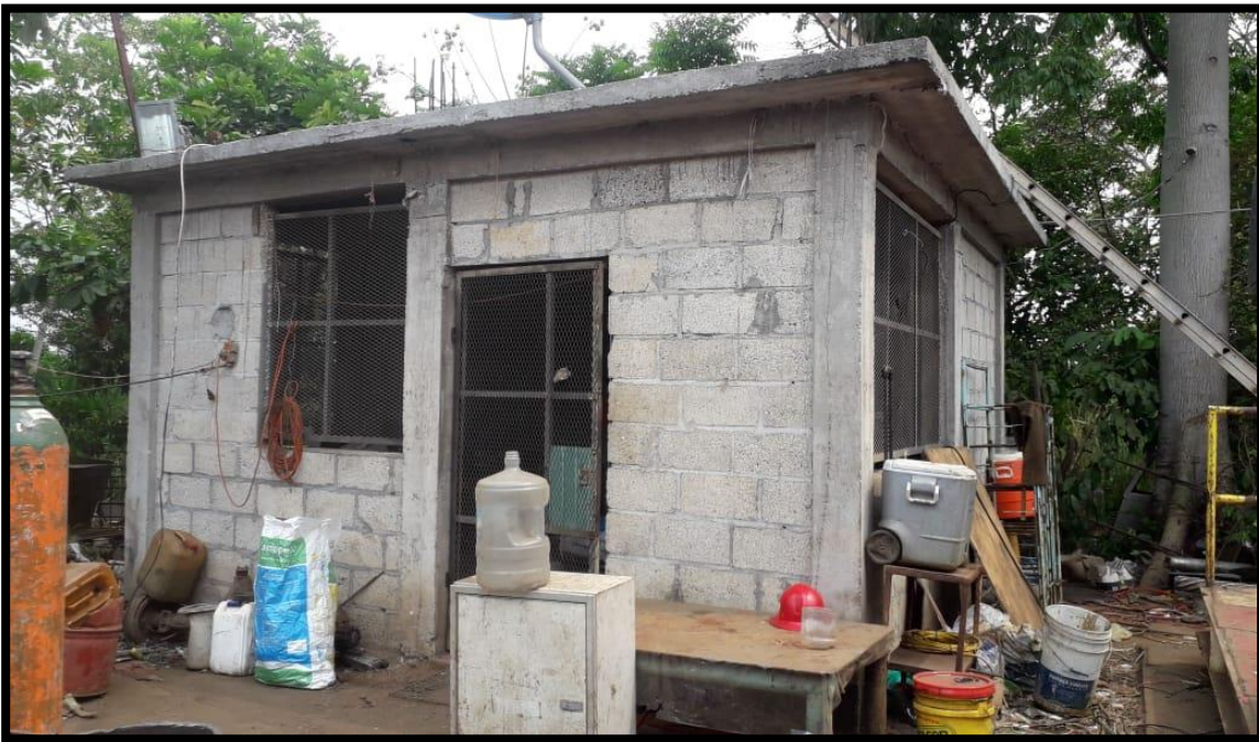
Figura.36 Oficina en mal estado
