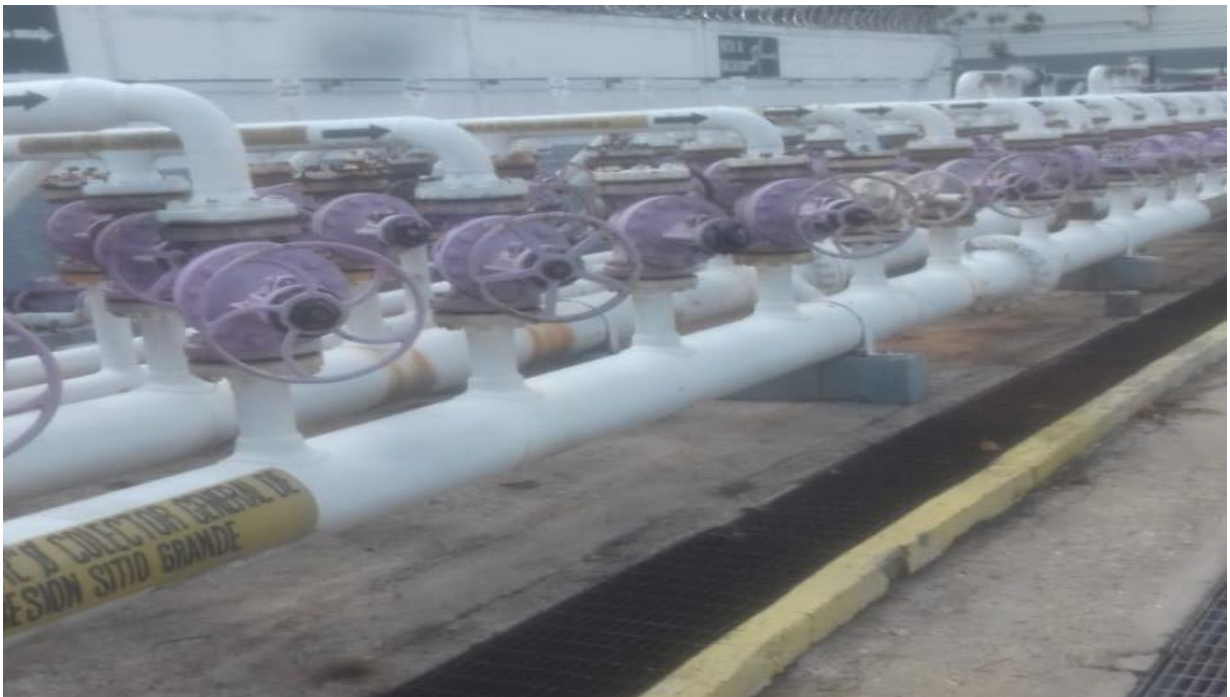
Figura 17 Cabezal de Pozo
