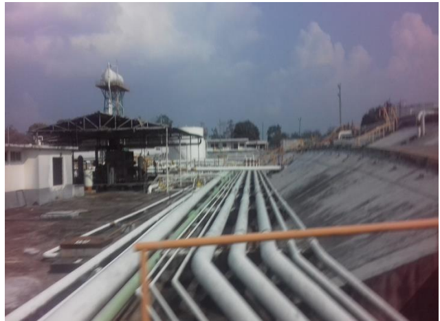
Figura 8 Tubería en el área
