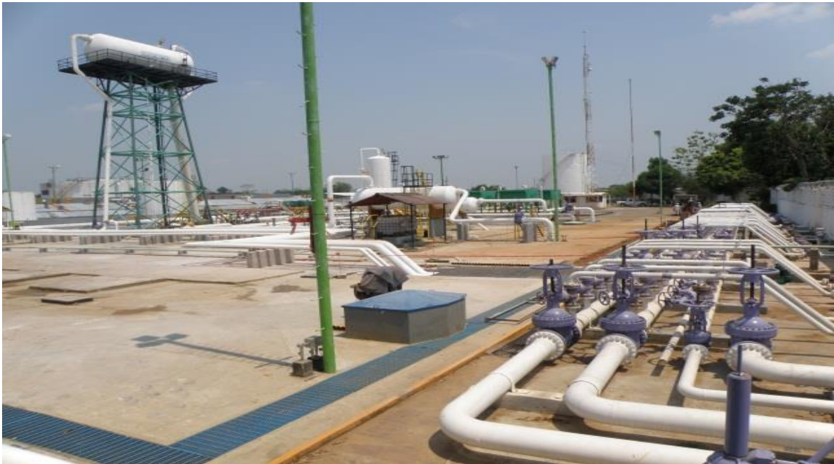
Figura 12. Líneas de conductos para crudo
