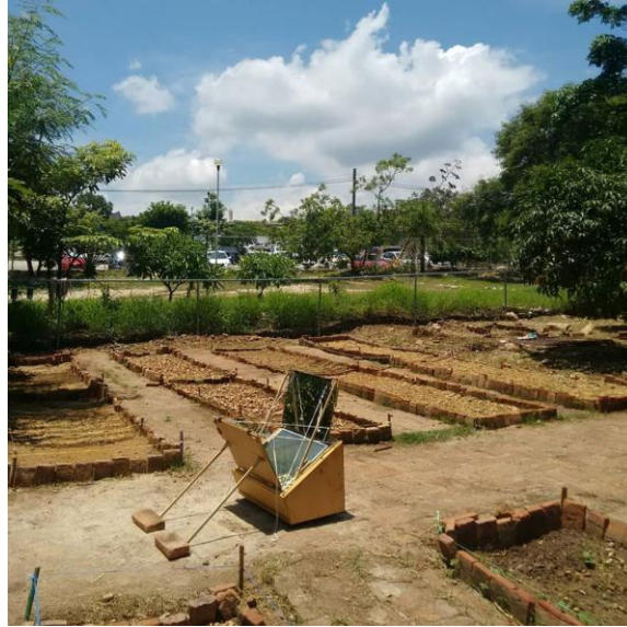
Figura 22. Construcción final de Horno solar ecológico, en el huerto MUIL ITAJ de la Universidad de Ciencias y Artes de Chiapas.
