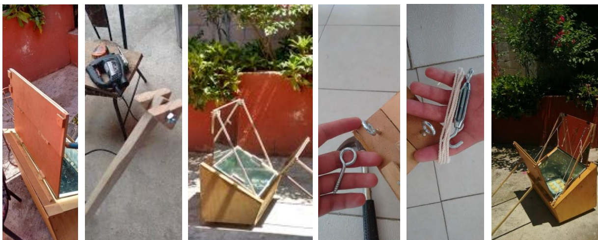
Figura 79. Pasos para finalizar la construcción de un horno solar con piedras de río, en su mayoría elaborado con materiales reciclados.
