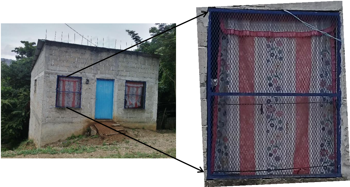
Figura 26. Vivienda y acercamiento de una ventana de ésta, la cual no contaba con protección.
