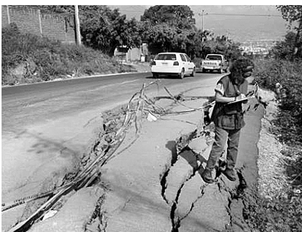
Foto 2 ■ | Deslave en carretera Tuxtla-Copoya km 0.500. Tomado en noviembre 2010. Foto JP.
