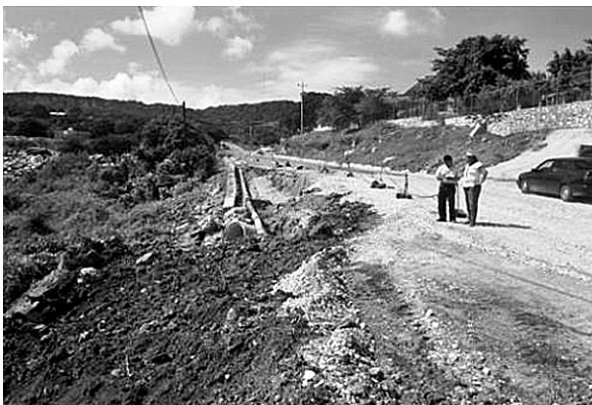
Foto 1 ■ | Deslave en carretera Tuxtla-Copoya km 0.500. Tomada en septiembre 2006. Foto JP.
