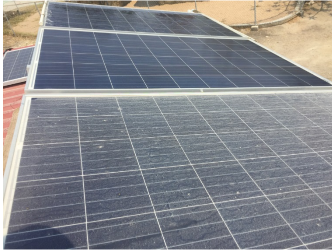
Figura 3.19.- Módulos FV: a) Con enfriamiento; b) Limpio; c) Sucio.
