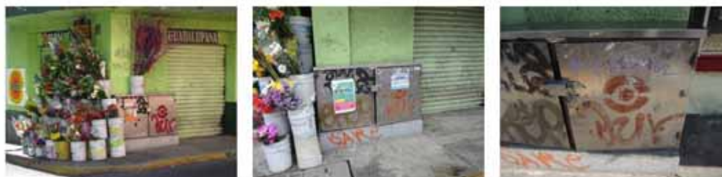
Figura 18: Caja de Telmex
